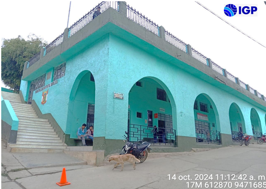
Figura 12.- Oficinas de la municipalidad distrital de Sapollica del primer y segundo nivel debajo de patio situado delante de parque principal de la ciudad, afectadas por infiltración de agua como efecto de las inundaciones pluviales
