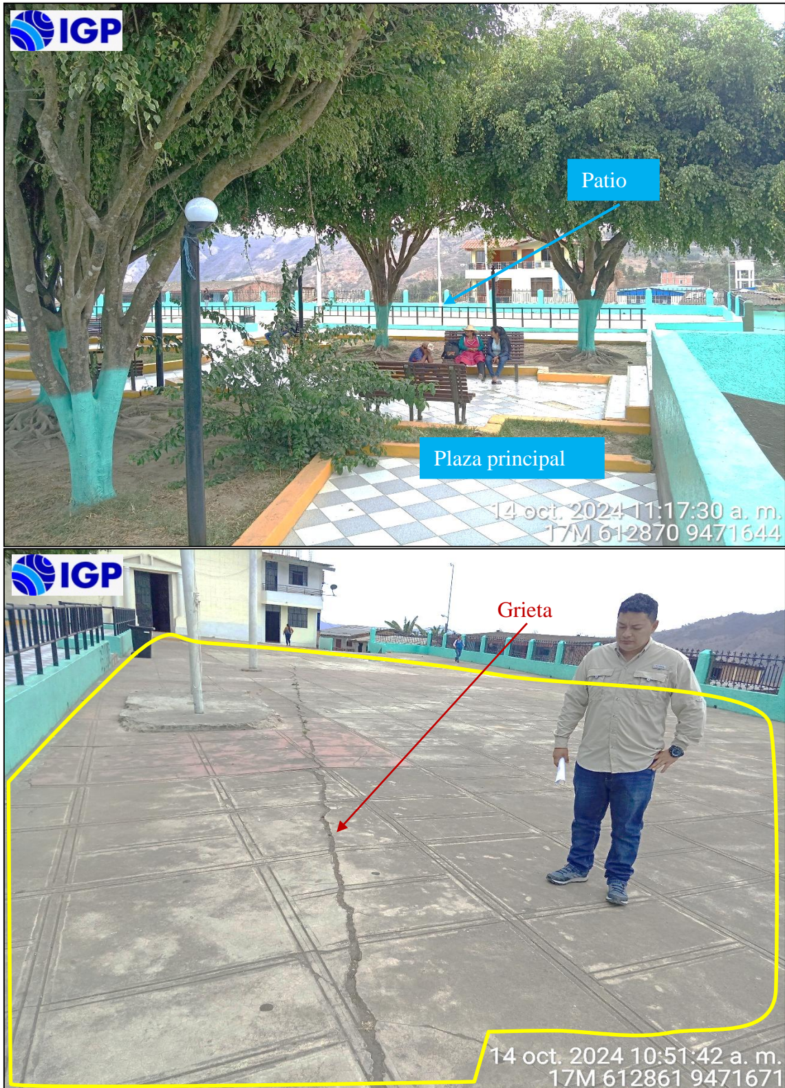
Figura 11.- Plaza de armas de Sapillica y patio afectados por inundaciones pluviales (polígono amarillo) durante los periodos de lluvia intensa, el agua acumulada se infiltra hacia la parte inferior de la losa de concreto y afecta las oficinas del palacio municipal de Sapillica
