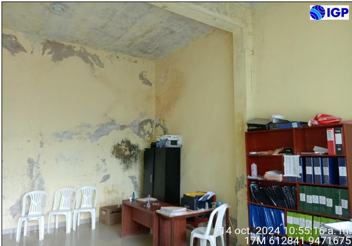
Figura 13.- Continuación.... Las oficinas de la municipalidad distrital de Sapillica presentan paredes y techos humedecidos por la infiltración del agua que podrían afectar equipos y la infraestructura física.
