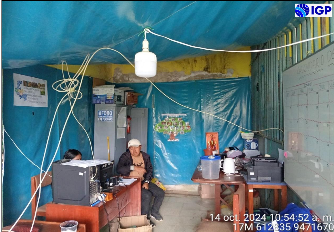
Figura 13.- Las oficinas de la municipalidad distrital de Sapollica presentan paredes y techos humedecidos por la infiltración del agua que podrían afectar equipos y la infraestructura física.
