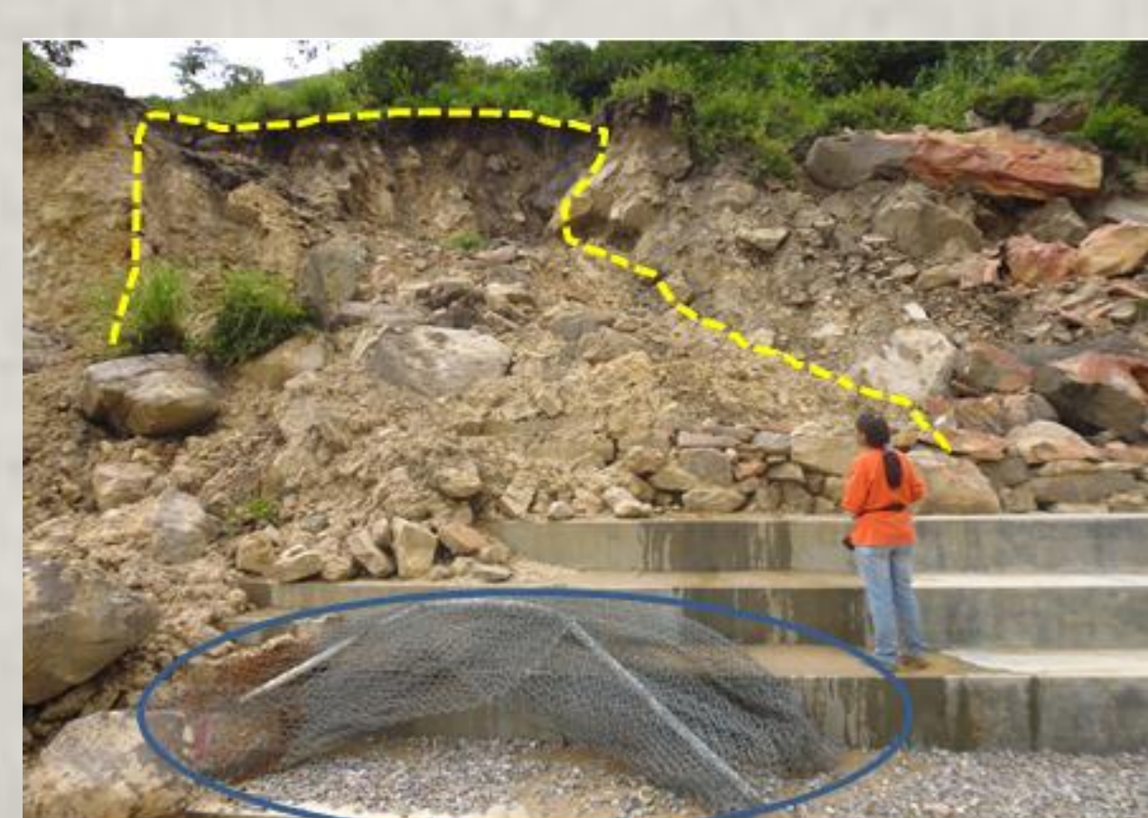
Foto 04: Deslizamiento de material, que afectó la losa deportiva de la localidad de Churuja, el círculo azul enmarca parte de la malla de protección derribada.
