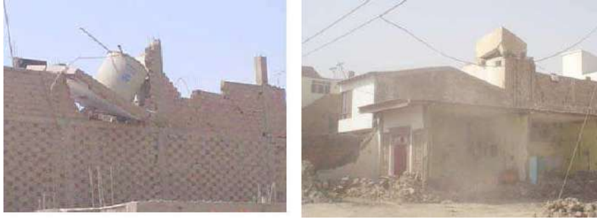
Figura 26.- Pisco, colapso de tanques elevados.
