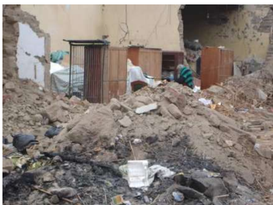
Vivienda de adobe colapsada, ubicada cerca de la Iglesia del Señor de Luren
