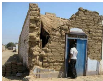
Daño Clase 4 - Coayllo
