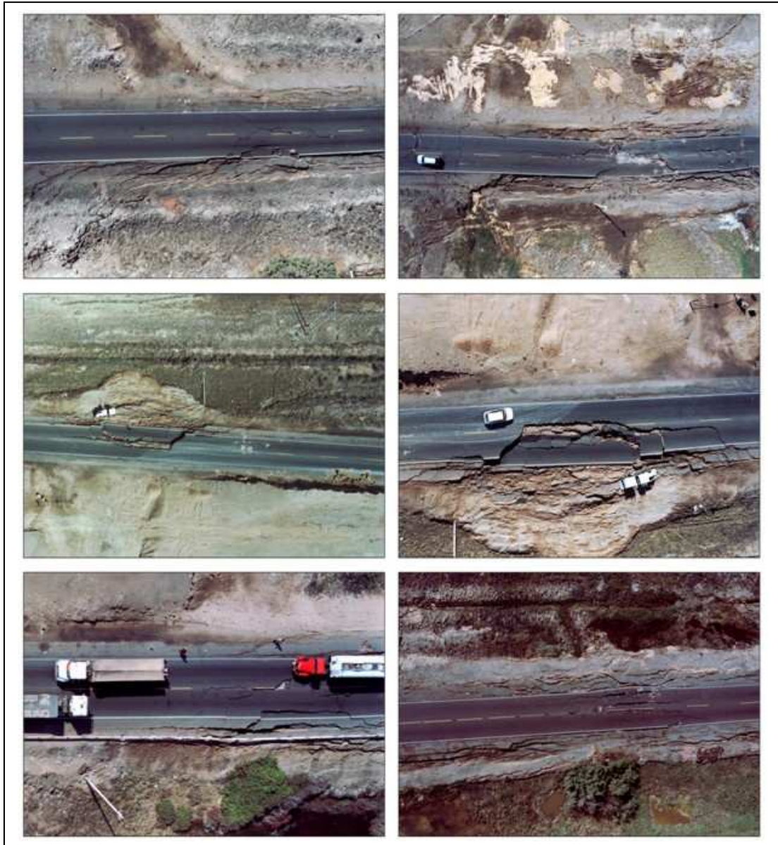
Figura 9.- En la carretera Panamericana Sur, se observo fenómenos de asentamientos de tierra, deslizamientos y procesos de licuefacción (Servicio Aéreoográfico Nacional).
