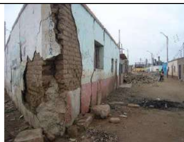
Figura 15.- Daños en Hualcarán.
