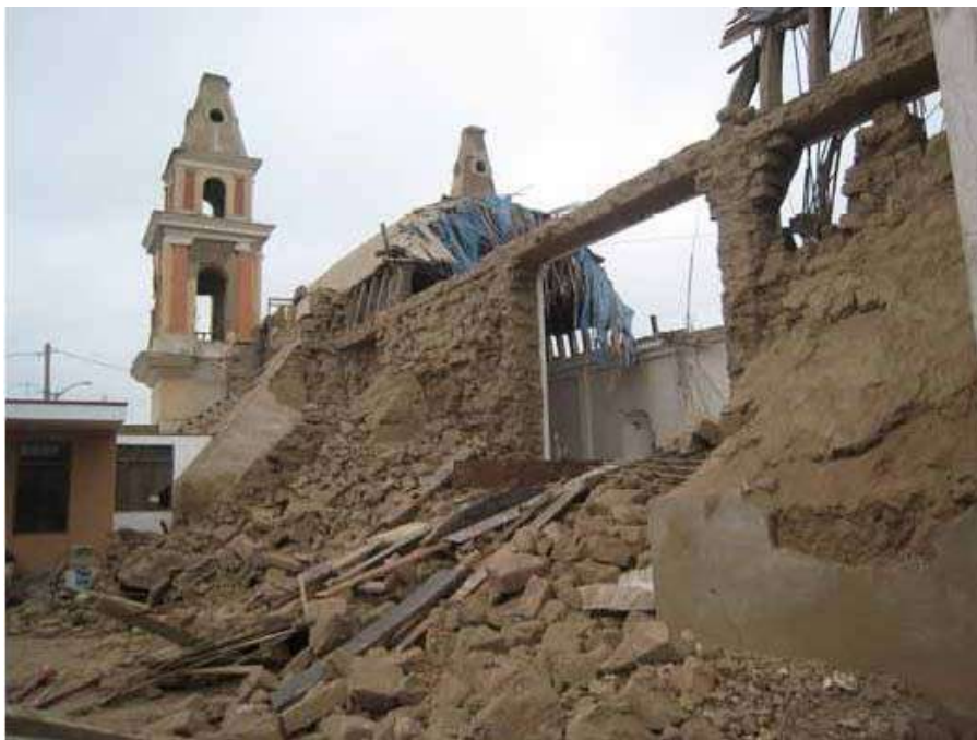
Figura 4.- La Iglesia de San Luis, La pared lateral y sus pesados pilares fueron prácticamente traídos abajo presumiblemente por el empuje dinámico del colapso de la bóveda. Las torres fueron hechas de quincha y sufrieron daños menores.
