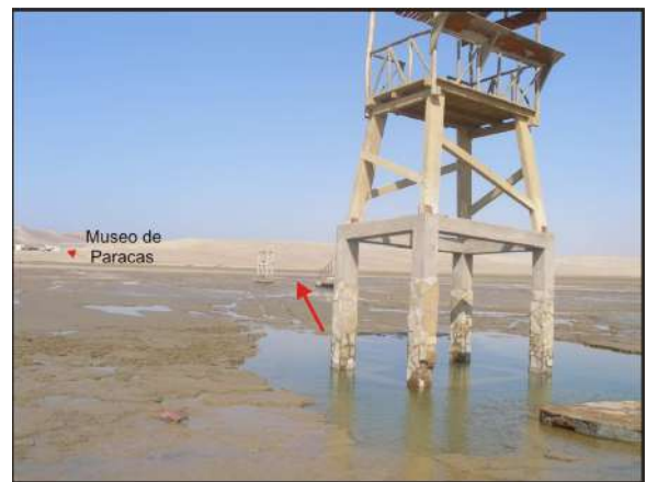
Foto 25.- Mirador de aves de madera y base de concreto socavado y parte de su estructura arrastrada a 45 y 54 m.
