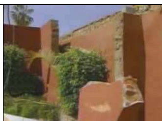
Figura 33.- Daños en Hotel.
