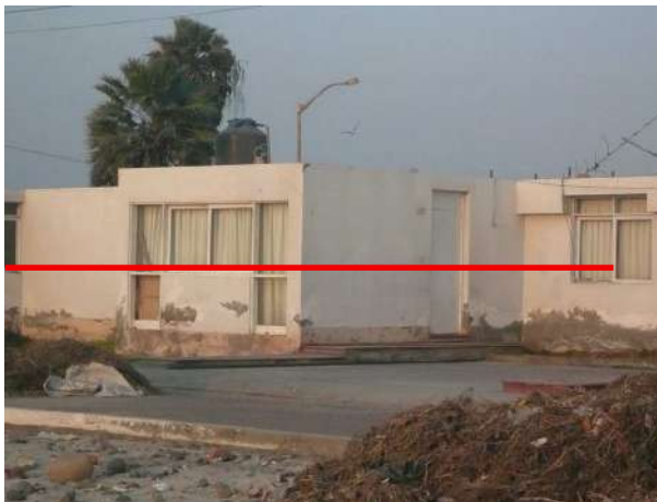
Figura 33.- Ciudad Militar cerca de la FAP. El run-up fue de 2 metros según indica las huellas en las paredes. Vigilante indica ver que el mar se retiró antes del tsunami.
