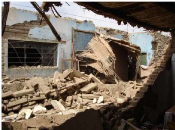
Vivienda de adobe con techos livianos de estera y cañas, dinteles de madera; colapsadas por diversos factores constructivos y antigüedad.
