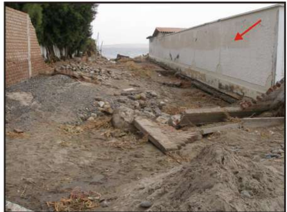
Foto 21.- Altura de la marca del agua en las viviendas de Paracas, ubicadas muy cerca del mar.
