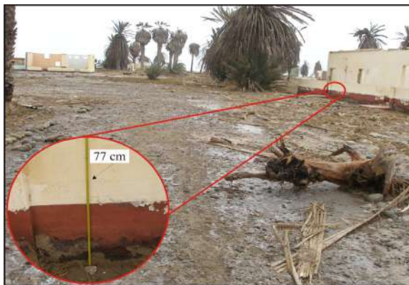
Foto 11.- Entrada a la playa El Chaco, donde se observa la marca del agua dejada en la pared.
