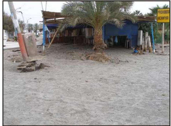
Foto 15.- Erosión del suelo producto del flujo y reflujo, dejando expuestas las bases de las estructuras.
