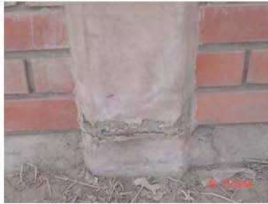
Figura 23.- Pisco, cerco alto y rótula en la base de la columna de arriostre.
