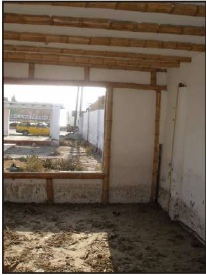
Foto 7.- Marca del agua y basura depositada por el tsunami en una vivienda de la villa militar en San Andrés.
