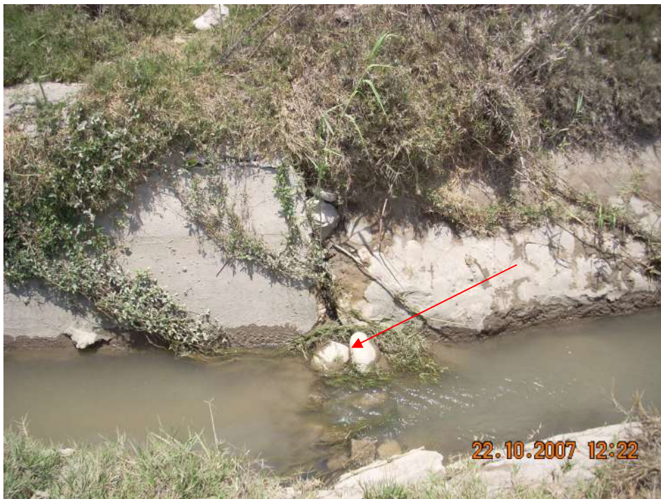
Figura 2.- Agrietamientos y colapso parcial del muro del canal de regadío en el Fundo Arteaga-Pisco.
