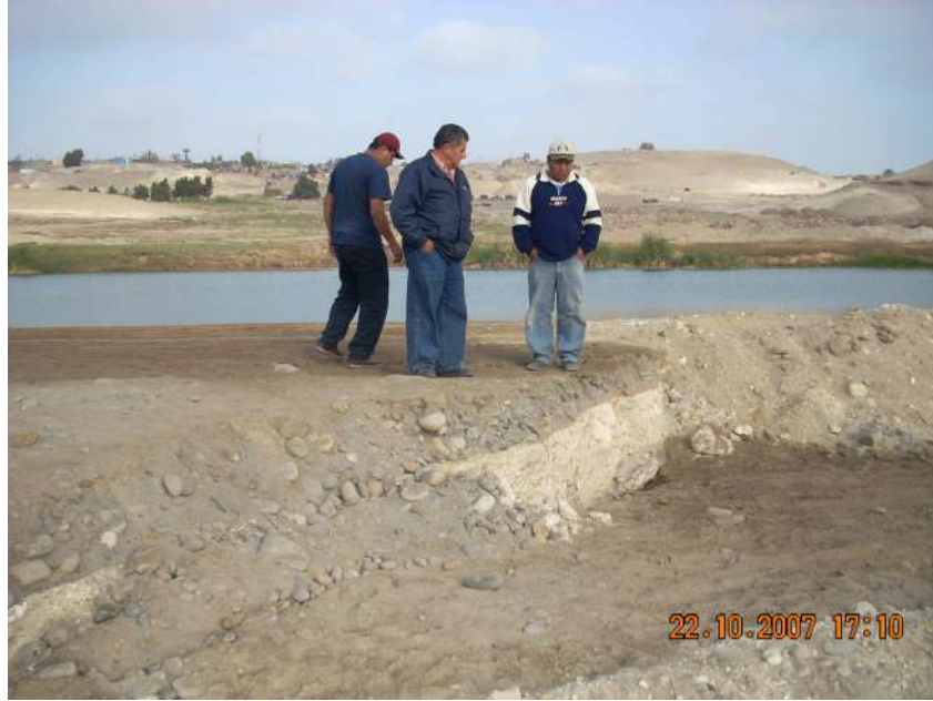
Figura 8.- Zona de las Lagunas de Oxidación, parte baja de San Clemente. Falla del terraplén por procesos de licuación de arenas.
