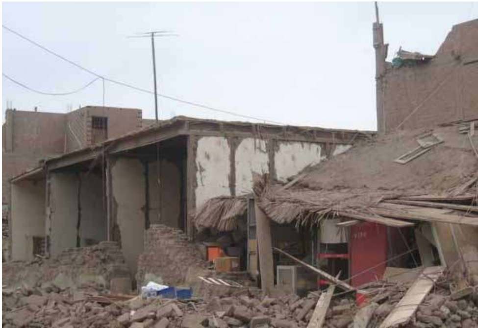
Figura 2.- Casas de adobe colapsadas en Pisco. Las vigas del techo de la casa de la derecha estaban apoyadas sobre las divisiones de quincha. Las vigas del techo de la casa de la derecha estaban apoyadas sobre la fachada de la pared, por lo tanto colapsaron con la fachada. Nótese a la izquierda la casa construida de material noble sin daños y en la parte posterior derecha el colapso de la fachada de una casa.
