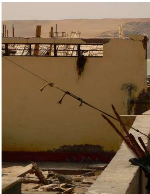
Figura 15.- Algas colgadas en las ventanas de las viviendas
