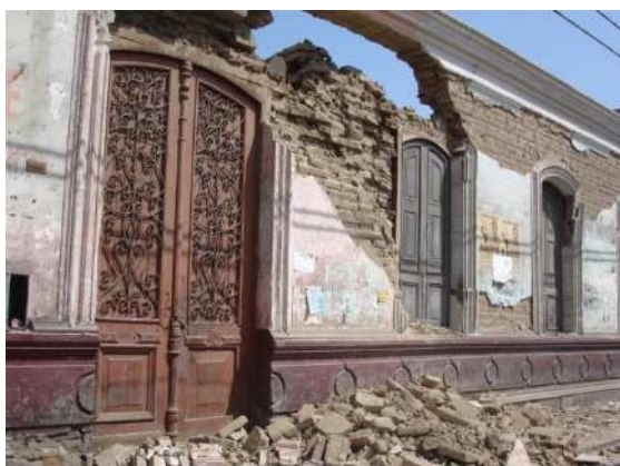
Vivienda de adobe ubicada en la Calle Loreto, nivel de daño clase 4.
