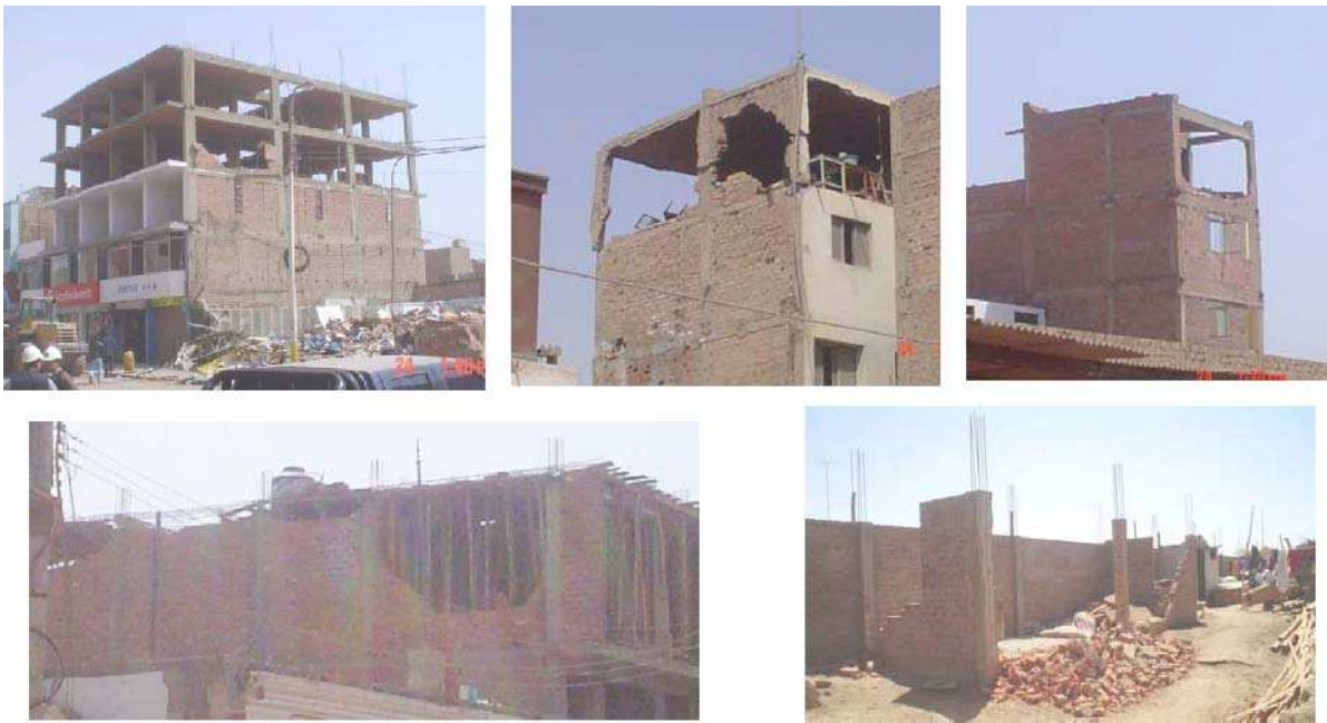
Figura 9.- Volcamiento de muros con junta a ras con las columnas. Inadecuadamente las columnas fueron construidas primero y después se levantó la albañilería. Pisco.
