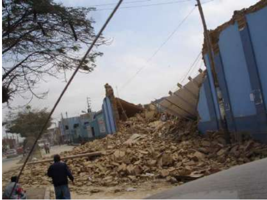
Muro colapsado, hospital de Chíncha.
