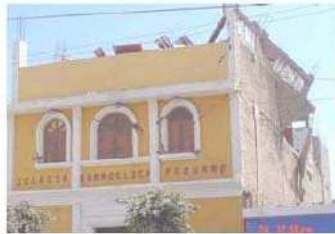
Muros sin diafragma rígido.
