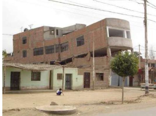
Edificio fallado debido a problemas de diseño estructural (Av. Unión de la ciudad de Chíncha).
