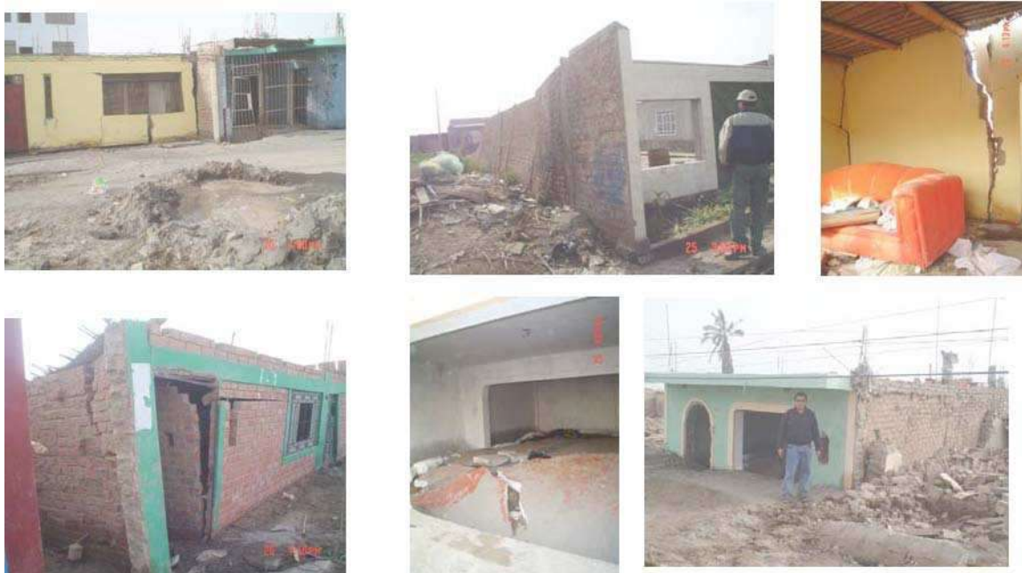
Figura 4.- Licuación en el humedal de Tambo de Mora.
