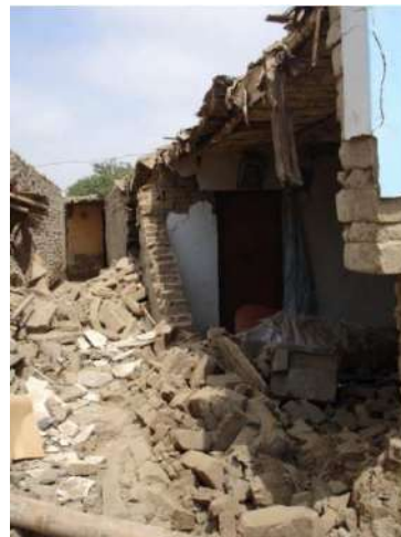
Vivienda de adobe ha fallado por los muros largos y sin restricciones transversales. Ubicada en Chíncha Alta
