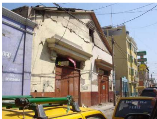
Vivienda de adobe ubicada en la calle Loreto, con daños severos
