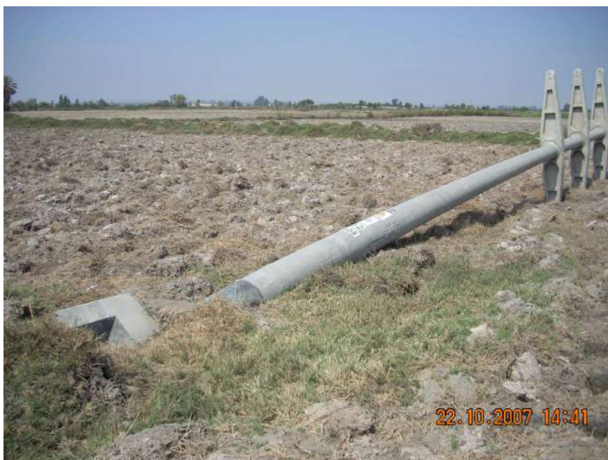
Figura 7.- Torre de alta tensión que colapso por falla del suelo: procesos de licuación de arenas – Hda. Tupac Amaru, Pisco.
