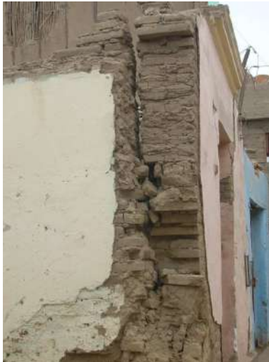
Detalle encuentro de muros- Sin conexiones dentadas entre sí.
