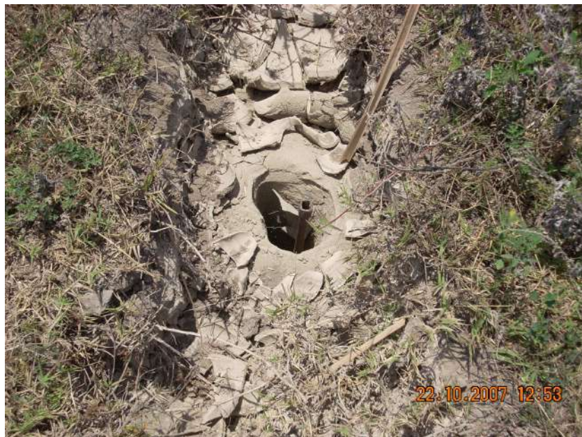
Figura 4.a.- Volcán de arena en zona de agrietamientos, producto de la licuación de suelos
