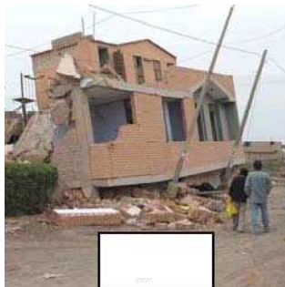
Figura 11.- Edificio construido con ladrillos de baja calidad.
