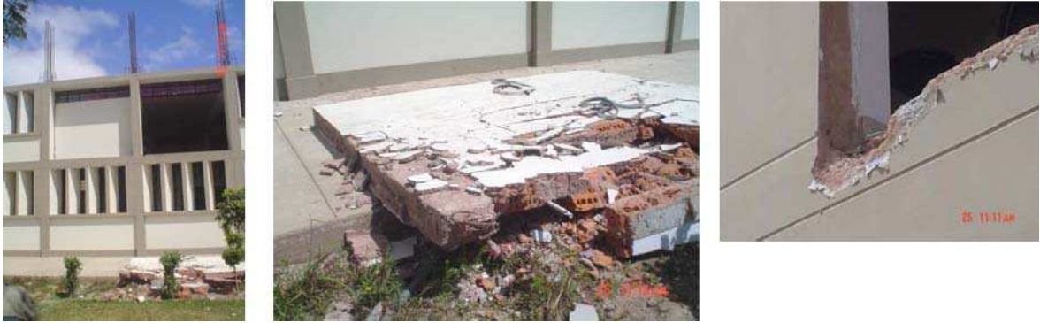
Figura 18.-Estructuras volcadas ante la acción sísmica transversal
