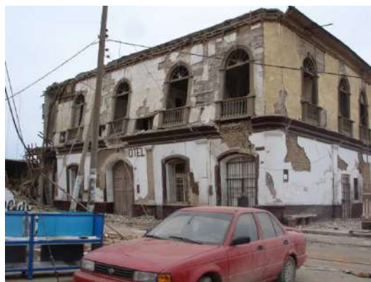
Hotel severamente dañado, ubicado en la Calle Manuel Pardo, Pisco Playa, construcción de adobe y quincha estructuras con rigidez diferente.
