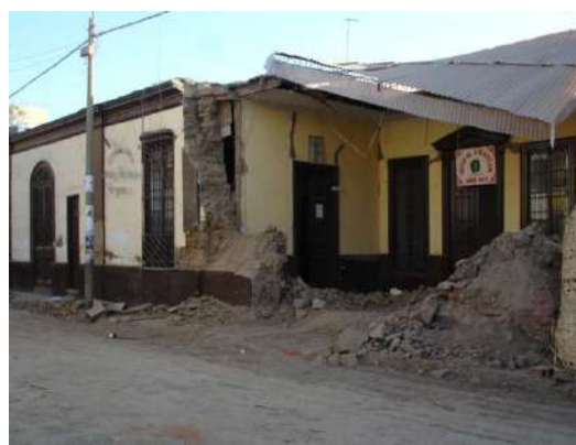
Vivienda de adobe ubicada en la calle Loreto, sin refuerzo en el encuentro de muros.
