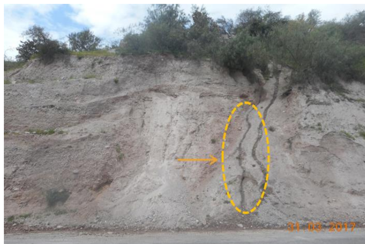
Figura 23: Infiltraciones de agua a 250 m, al sur-oeste de la plaza principal de Torata, en el sector denominado (Cerro cruz del siglo).
