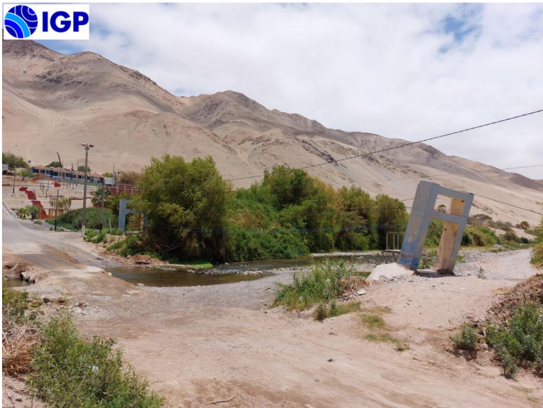
Figura 17: Sector del Algarrobal afectado por el desborde del río Osmore, afectando el puente colgante.
