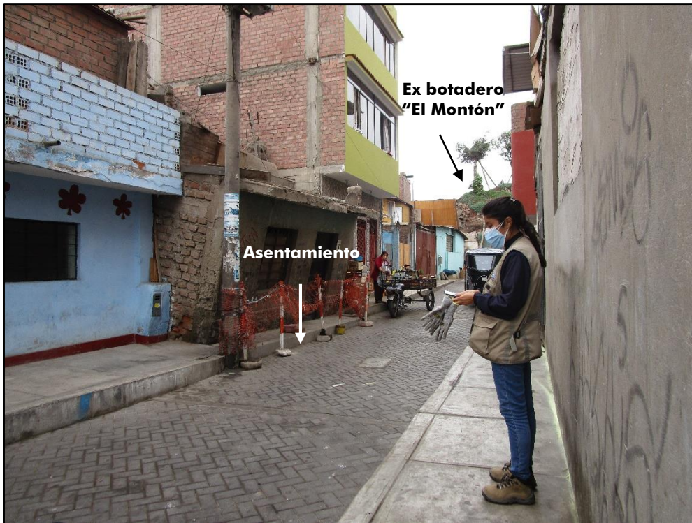
Figura 16. a) Vista de vivienda con paredes inclinadas por efectos del asentamiento del suelo: AA.HH. Villa María del Perpetuo Socorro, próximo al Complejo Deportivo Villa María (ex botadero "El Montón")
