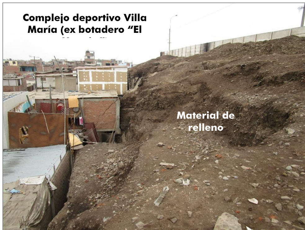
Figura 15. d) Vista del material heterogéneo de origen antrópico sobre el cual se encuentran diversas estructuras: parte alta del Complejo Deportivo Villa María, AA.HH. Villa María del Perpetuo Socorro.
