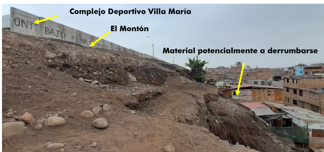
Figura 11. Zona con potencial para generar derrumbes. Se evidencia que el material no está compactado, sino deleznable al tacto debido a que está conformado por desechos de materiales de construcciones (ladrillos, maderas, otros), desechos antrópicos, arenas, limos, gravas (alóctonos), entre otros. De ceder el material puede afectar a las viviendas asentadas en la parte baja (calle 15 de agosto).
