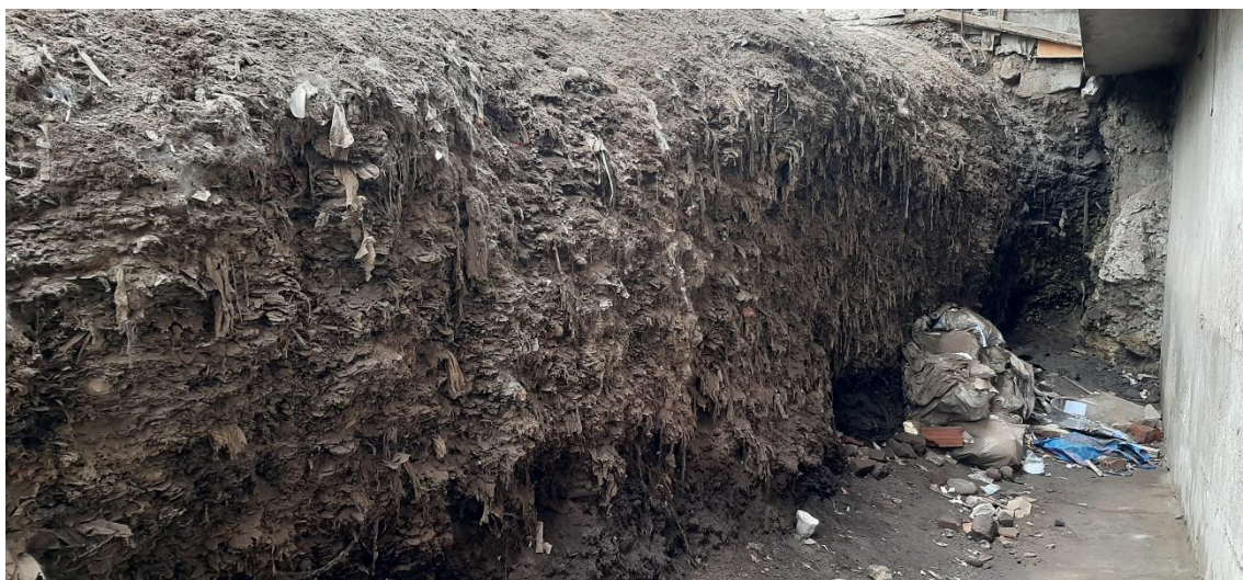
Figura 13. Material sobre el cual se asientan las viviendas en la MIRR. Se observa que está conformado por desechos antrópicos (botadero antiguo de Lima), presenta humedad media producto de la descomposición de los mismos.
