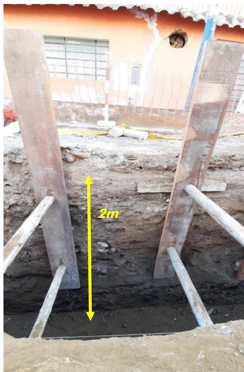
Figura 7. Calle ubicada en el AA.HH. Dos de Mayo. Se evidencia que los suelos sobre los cuales se asientan las viviendas están conformados por materiales heterogéneos, alóctonos (material de desmonte, construcciones, entre otros) que probablemente formaron parte del antiguo depósito de relleno antrópico de Lima Metropolitana.
