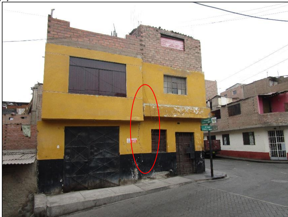
Figura 51. Daños en viviendas ubicadas en el AA.HH. 1° De Mayo (a) y la intercepción del Jr. Reque y Ca. Huancarqui, en el AA.HH. Villa María del Perpetuo Socorro (b), por efectos del asentamiento del suelo
