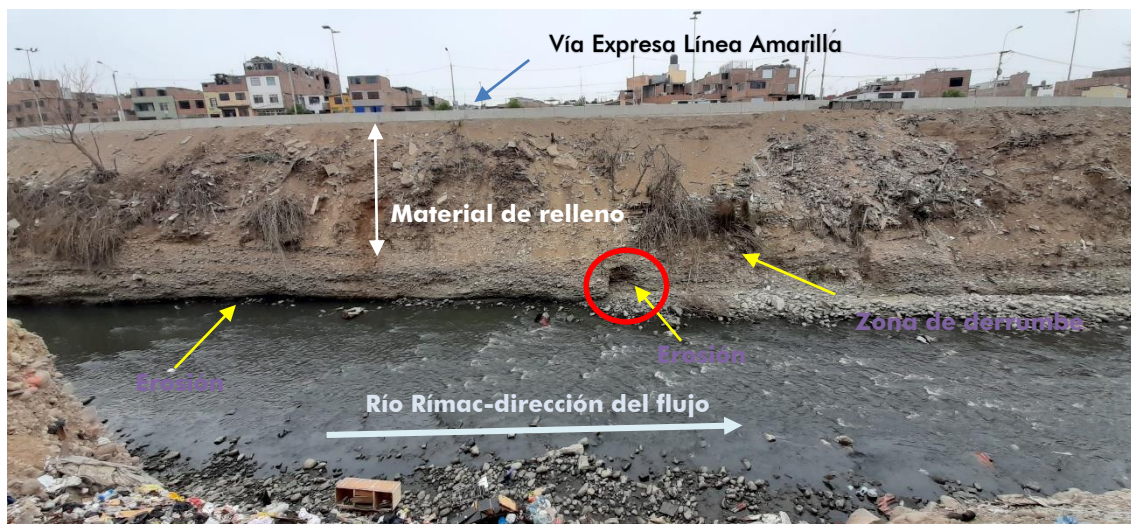
Figura 10. Margen izquierda del río Rimac. Se evidencia la erosión de los materiales (Depósito fluvio aluvial) en la base del talud de la ribera y provocara el derrumbe del material de relleno. Asimismo, se ha identificado socavamientos (círculo rojo) en el talud que podría generar la inestabilidad del mismo. Esta condición se presenta a lo largo del área de estudio.
