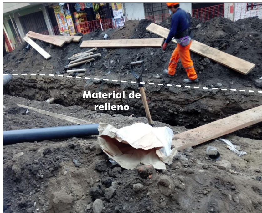
Figura 15. c) Vista del material heterogéneo de origen antrópico, rellenos con presencia de humedad: AA.HH. de 1° de Mayo.
