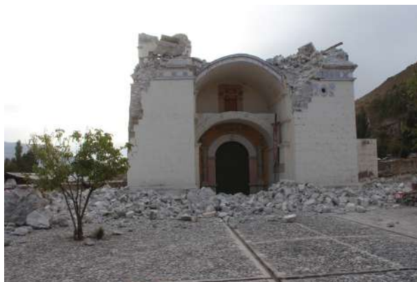
La iglesia del distrito de Ichupampa quedó destruida tras el sismo del 14 de agosto.
