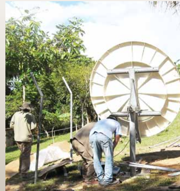
Instalación de la estación acelerométrica de Yurimaguas (Loreto).
