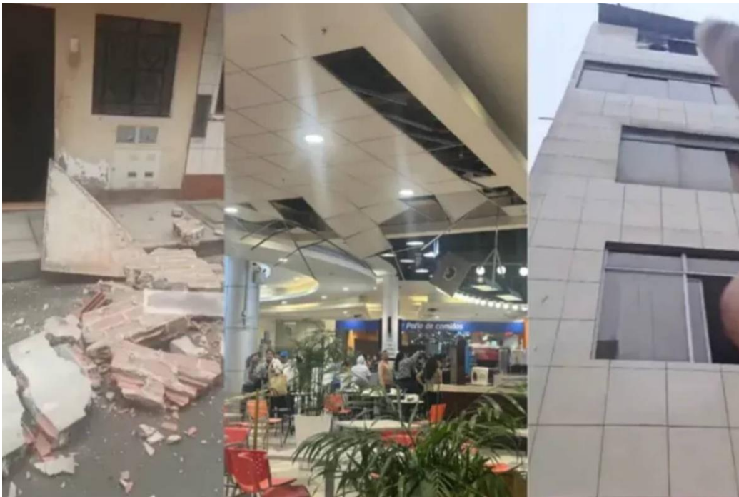
Figura 8b.- Daños en viviendas, centros comerciales y edificios debido al sacudimiento del suelo producto del sismo del 15 de junio 2025 (M6.1). (Fuente: EFE)
