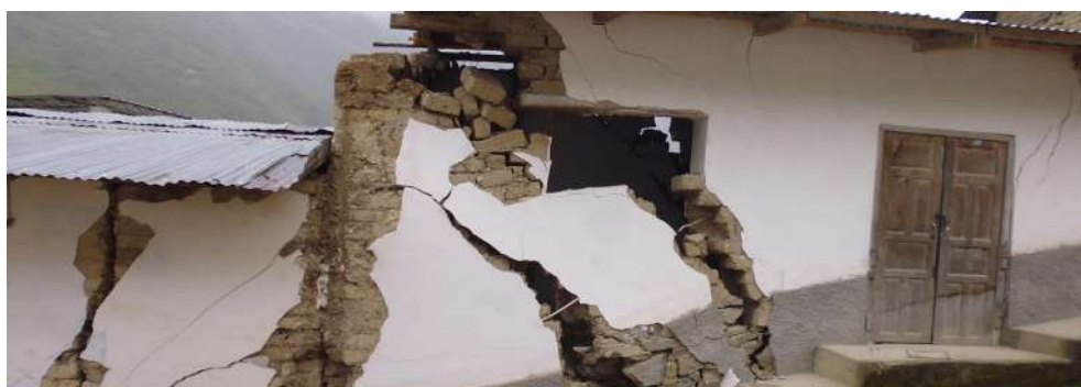
Efectos sobre la infraestructura física del deslizamiento rotacional que afecta al distrito de Sócola, provincia de Cutervo, región Cajamarca.
