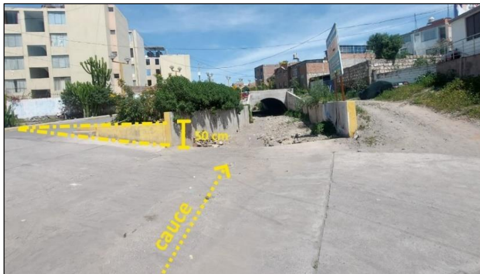
Figura 14. Desnivel observado entre cauce de quebrada y viviendas construidas. P. J. Buen Amanecer.
