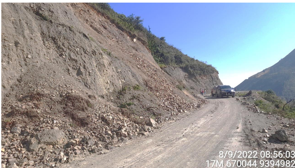
Figura 11.- Materiales removidos pendiente debajo de ladera que podrían afectar la vía Lanchales - Cuce .
