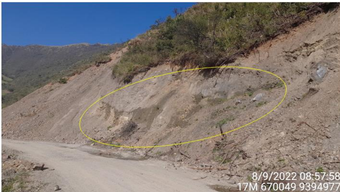
Figura 10.- Infiltración de agua (elipse amarillo) sobre el talud como evidencia de la saturación de los suelos y rocas que conforman la ladera.
