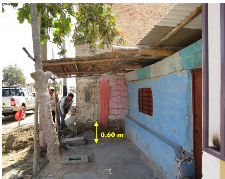
Figura 13: Vivienda localizada en el Sector urbano 8 de Diciembre afectado por inundaciones, se evidencia la marca de la altura de agua que llegó a 0.60 m.
