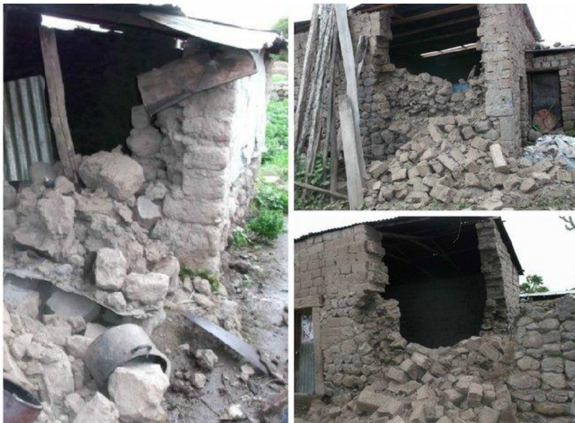
Figura 7. Viviendas de adobe dañadas por colapso en la localidad de Cabanaconde
