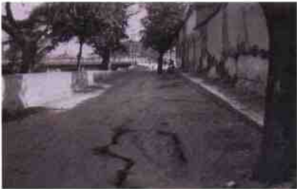
Figura 4. Grietas cosísmicas en el margen del río Manzanares, estado Sucre, en el terremoto de 1929. Fuente: Palge (1930).
