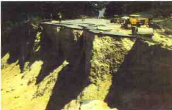
Figura 6. Terraplen deslizado en San Josesito, en el terremoto de 1981. Fuente: FUNVISIS (1982).
