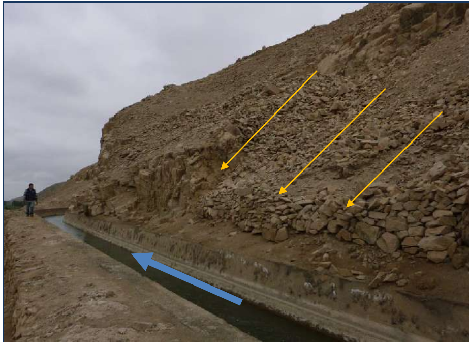
Figura 44: Cerro Yamayo y desprendimiento de rocas fracturadas dentro del canal de regadío
