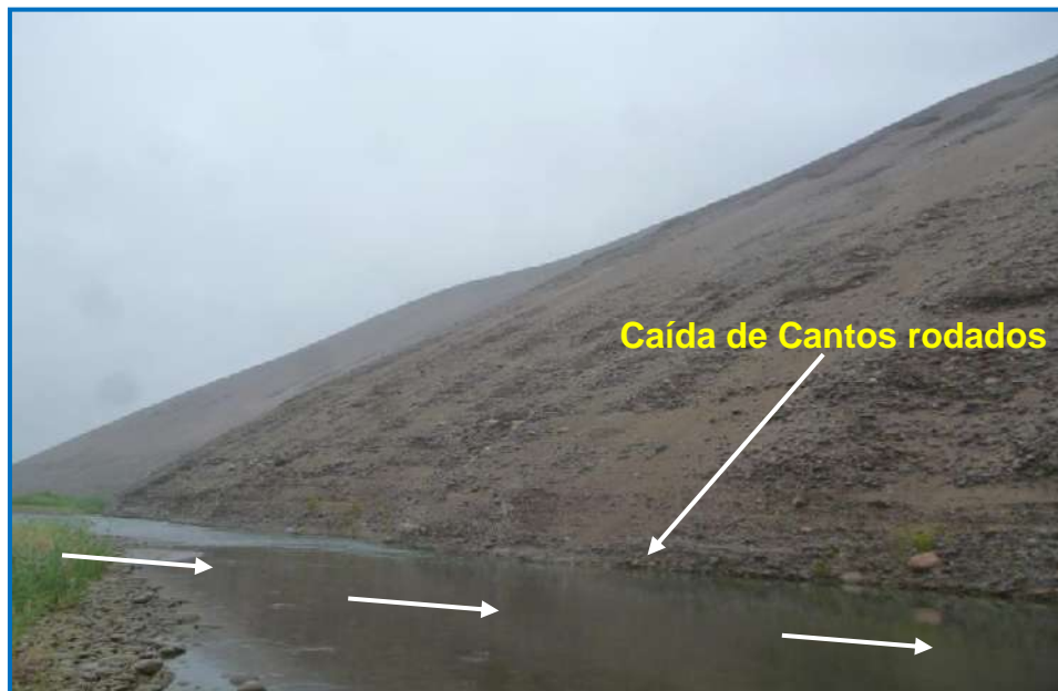
Figura 47: Margen izquierda del río Tambo en continuo proceso e rosión.
