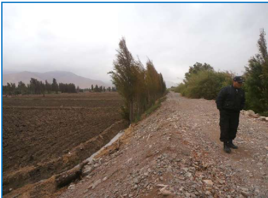
Figura 48: Margen derecha del río Tambo con defensas ribereñas que no alcanzan más de 2.5 metros de altura; por tanto, son proclives al desborde.
