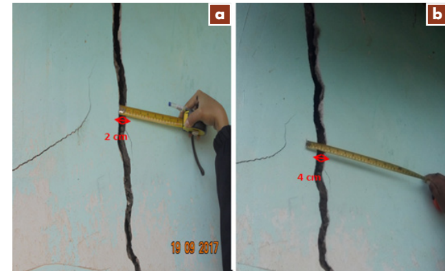
Figura 20. Grietas en infraestructuras. a) Medición de abertura 2 cm en el año 2017. b) Abertura de 4 cm en 2018.
