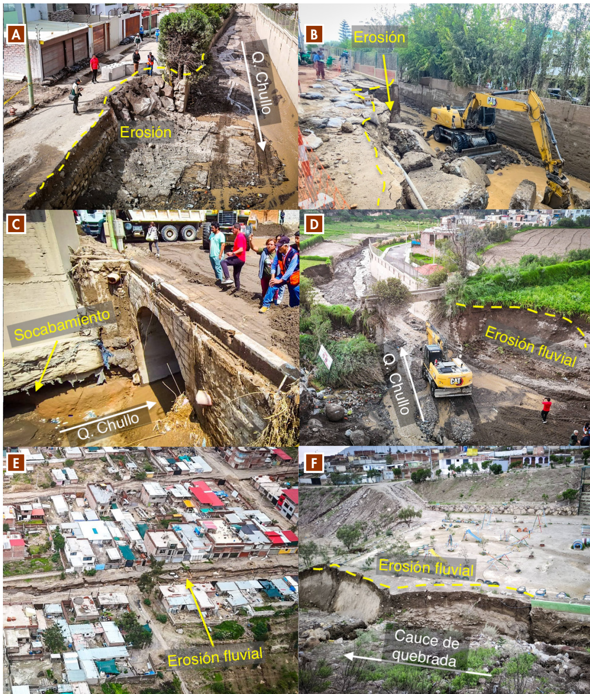
Figura 16. A y B) Quebrada Chullo en los sectores Rosario I y II, donde se registró el colapso parcial de los muros de contención. C) Arquillo I, donde se observa el socavamiento y debilitamiento de las márgenes de la quebrada. D) Arquillo III, donde ocurrió erosión fluvial de zonas agrícolas. E) Erosión fluvial en ambas márgenes de la quebrada Chullo en la urbanización Rosario I. F) Asociación Chachani I y II, donde se observan cárcavas formadas por acción erosiva de los lahares. G) Asociación Don Francisco, donde ocurrió erosión de la margen derecha de la quebrada Chullo.
