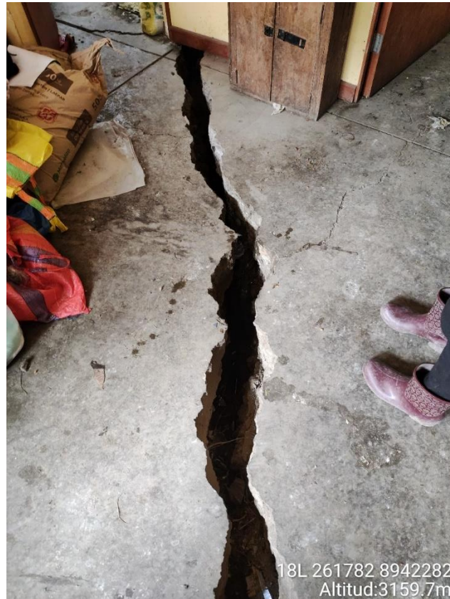
Figura 13. Grietas de hasta 12 cm en vivienda afectada por deslizamientos.
