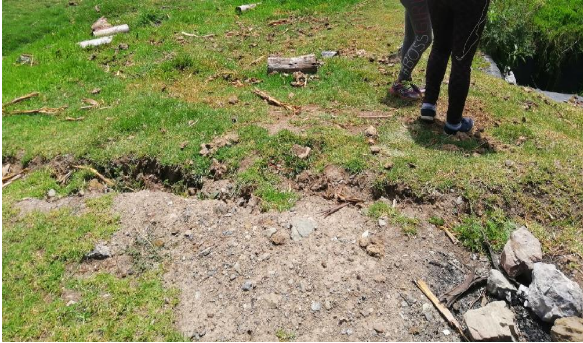
Figura 4. Se observa que hay un agrietamiento en el suelo, lo cual aparece en la mayoría de los terrenos agrícolas de Millhuish, principalmente aquellas que se encuentra cerca al río Mosna. Extraído del informe N° 248-2020-MDSM/GM/UGRD/JPTM.
