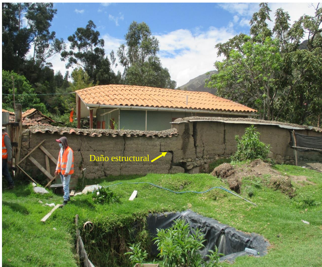
Figura 3. Asentamiento del suelo y presencia de agrietamientos en estructuras de albañilería.
