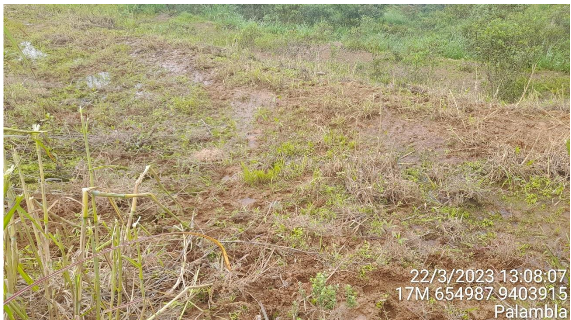
Figura 26.- Acumulación de agua en la plataforma de los taludes del DME 04 que podría generar la saturación de los materiales que lo conforman y su posterior inestabilidad.
