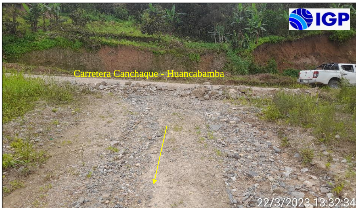
Figura 22.- Erosión de suelos debido al flujo de escorrentía superficial que proviene de la vía Canchaque – Huancabamba e ingresa a DME 01.
