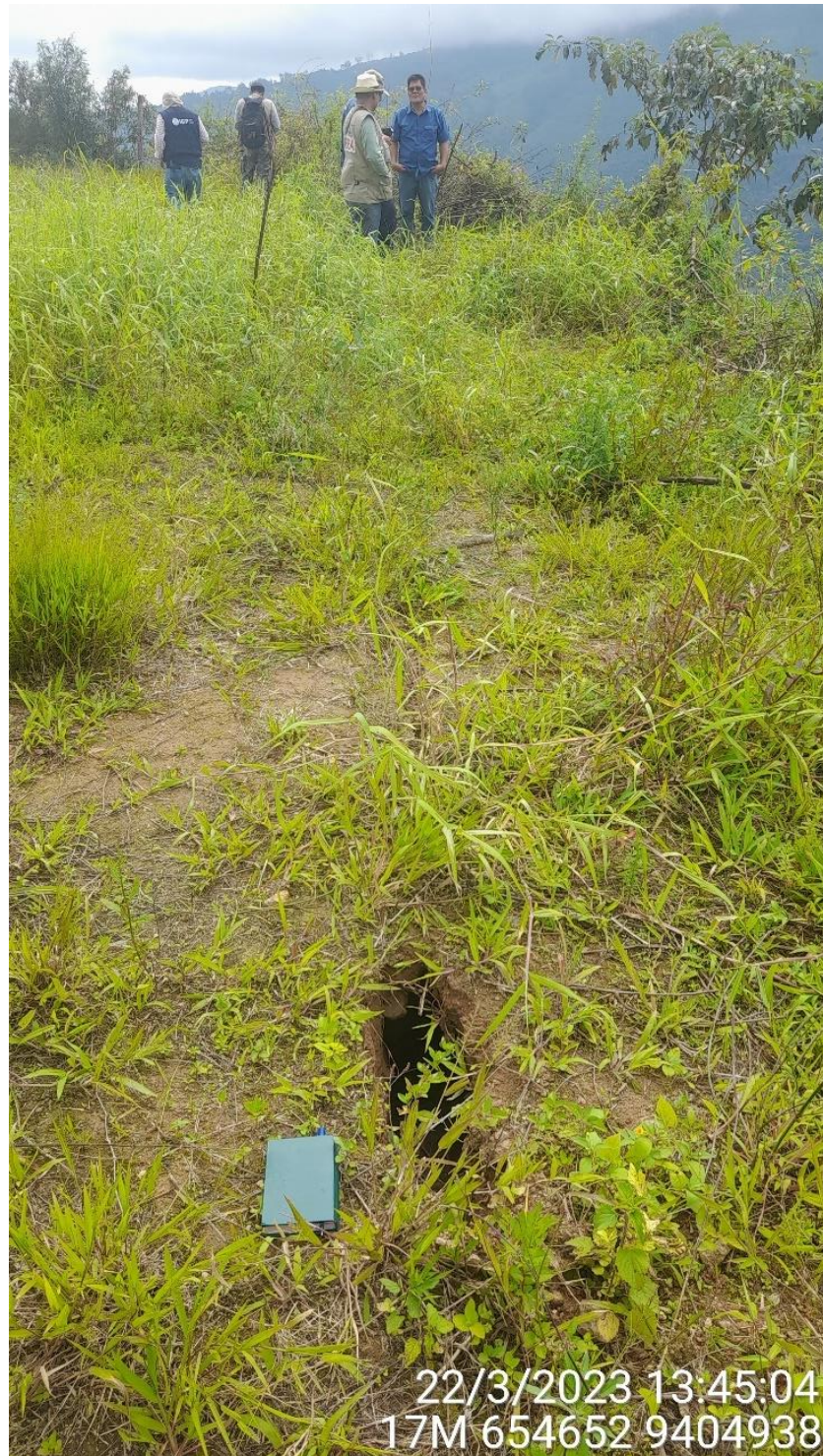
Figura 23.- Grieta en el suelo que conforma el DME 01 de aproximadamente 18 m de longitud, ancho máximo de 0.40 m y profundidad de 0.50 m
