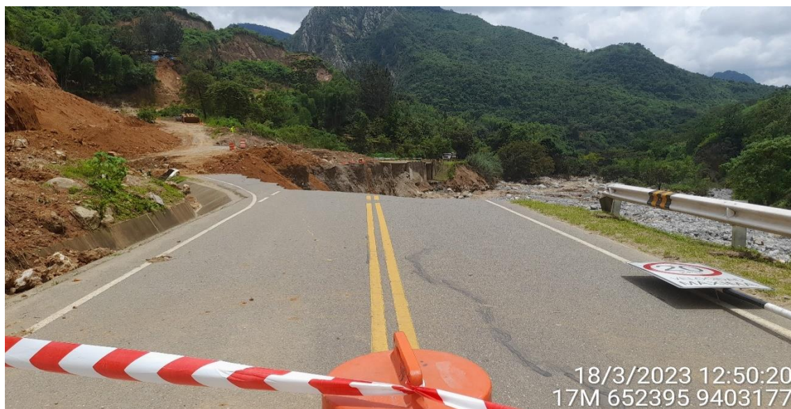
Figura 28.- Colapso de un tramo de la plataforma de la vía Piura – Canchaque debido a la ocurrencia del fenómeno erosión fluvial ante el incremento del caudal del río
