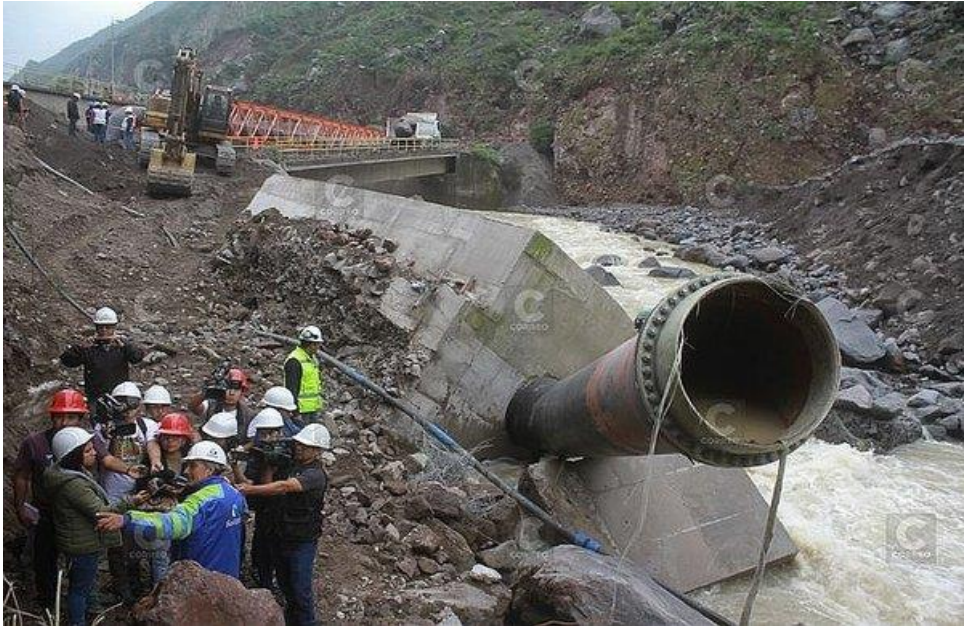
Figura 14.- Vista de la planta de captación de agua potable de la Tomilla II de SEDAPAR afectada por un lahar en febrero de 2017 (Foto: Diario Correo)
