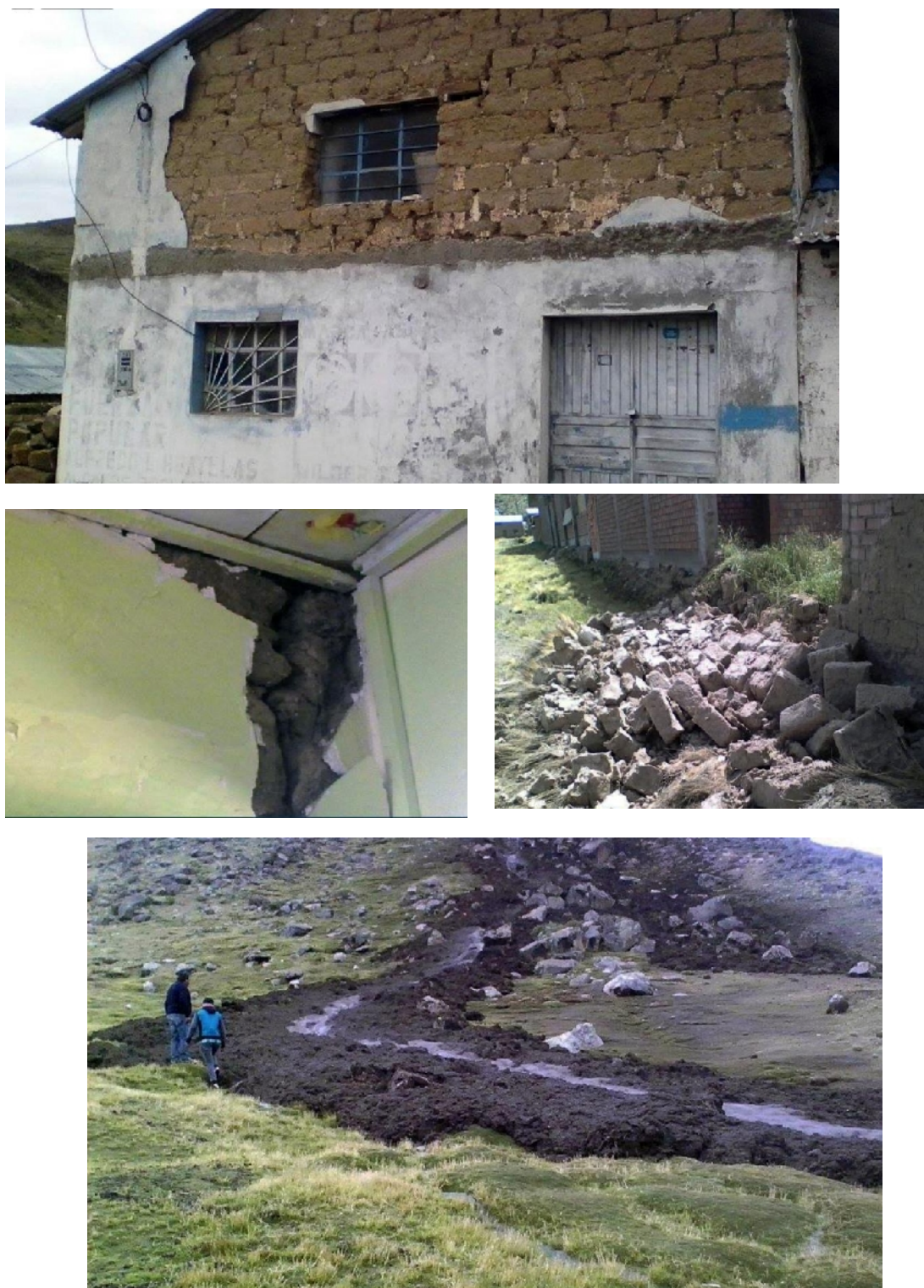
Figura 6. Imágenes de diversas viviendas en Pampamarca construidas con adobe y piedras que colapsaron por la fuerte intensidad de sacudimiento del suelo debido al sismo de Pampamarca (fuentes RPP).
