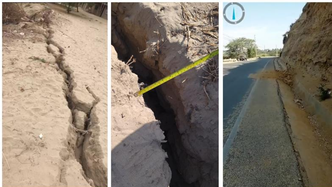
Figura 13.- Ejemplos de suelos con fisuras en zonas de sembríos y carreteras debido al sismo de Sullana del 30 de julio 2021.
