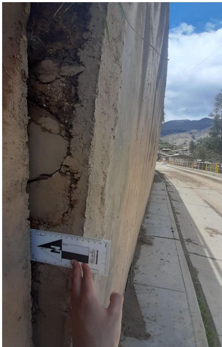
Figura 3. Vivienda en la cual se muestra el desplazamiento de uno de sus muros como producto del empuje generado por el desplazamiento del suelo.
