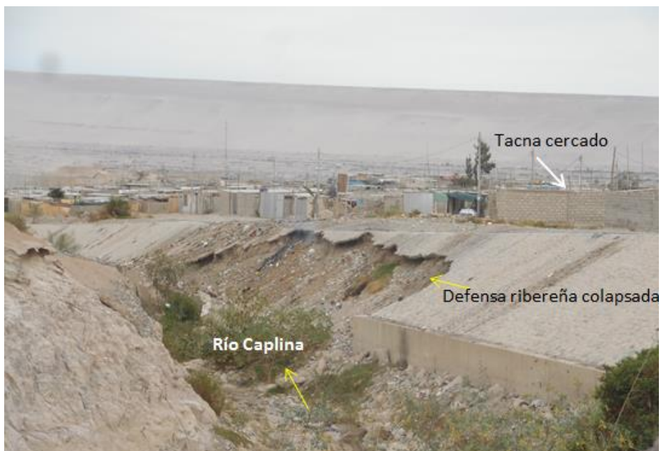
Figura 23: Río Caplina que ante el incremento de su caudal que sobre pasa la capacidad de embalse produciría un desborde que afectaría la infraestructura física de Tacna.
