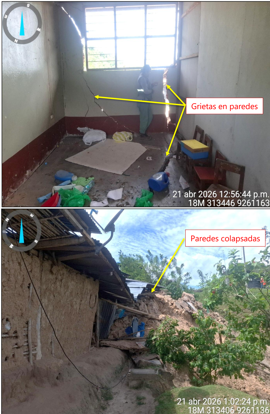
Figura 25.- En la imagen superior se aprecian grietas en paredes y piso del IEI N°429 de 10 a 15 cm de ancho y en la imagen inferior, paredes de adobe colapsadas de algunas viviendas.
