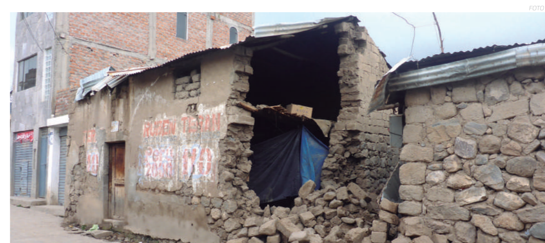
Figura 03.- Vivienda de adobe en el pueblo de Cabanaconde dañada tras los sismos superficiales ocurridos en el mes de febrero.
