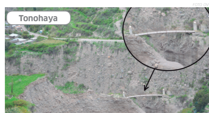
Figura 06.- Puente peatonal cercano al poblado de Tonohaya clausurado debido al debilitamiento de sus bases.
