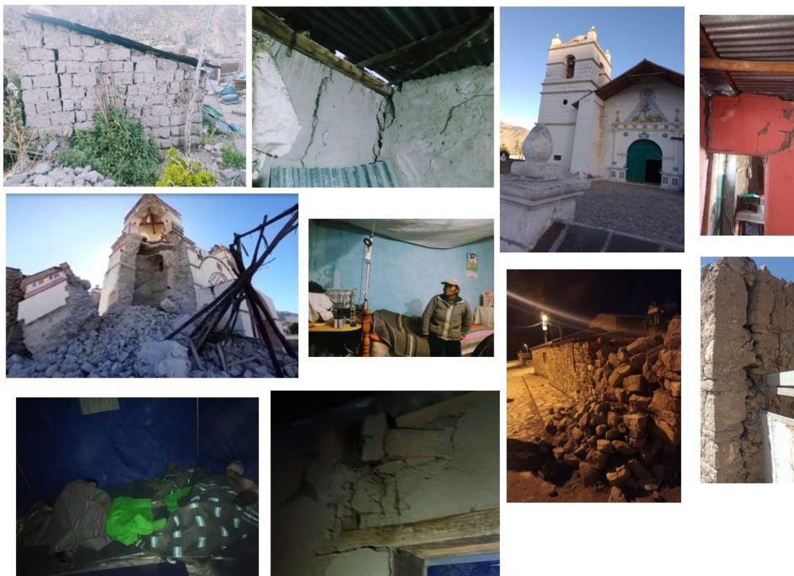
Figura 10: Daños en viviendas y templos contruidos con material de adobe debido a los sacudimientos del suelo producidos por el sismo precursor del 28 de mayo (M4.5) y sismo principal del 2 de junio (M5.2) en localidades ubicadas en el área epicentral.
