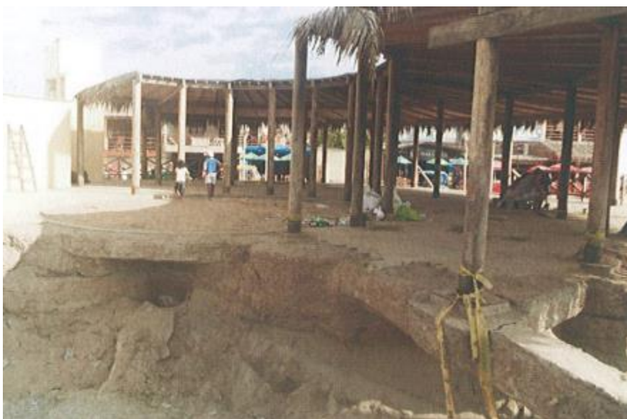
Figura 6: Mirador central afectado por oleaje (Fuente: DHN, 2013).
