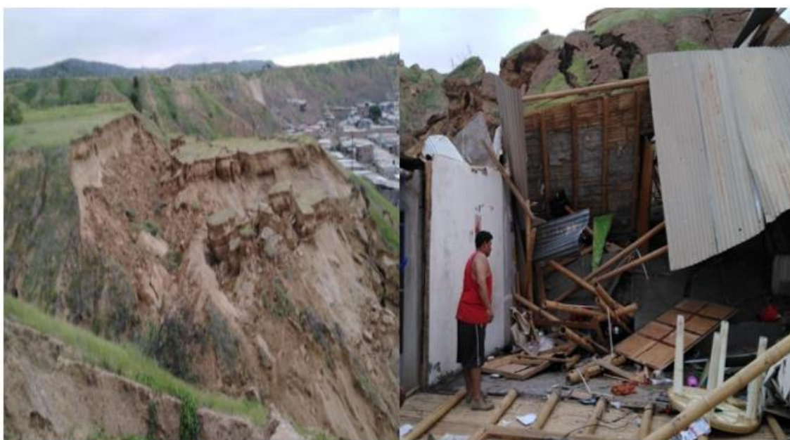
Figura 4: Deslizamiento de cerro en Máncora, sector Uno de Mayo, provincia Talara, región Piura (Fuente: Diario El Comercio).
