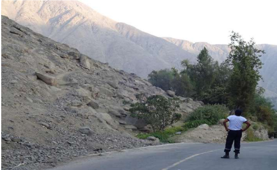
Figura 41: Caída de rocas provenientes de la ladera, de los cerros y que interrumpe el paso de los vehículos en la carretera de Cañete-Yauyos.
