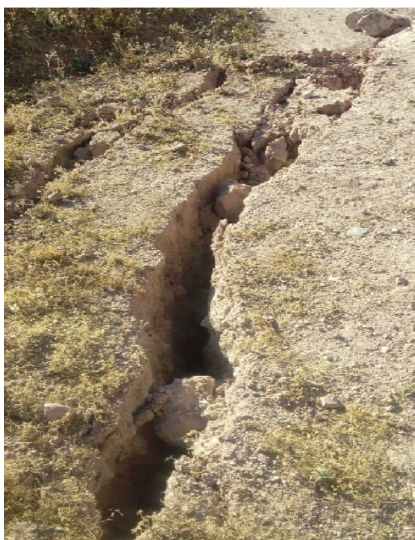
Figura 11: Agrietamientos transversales en ladera de colinas en sector Labramane. (agosto 2020)
