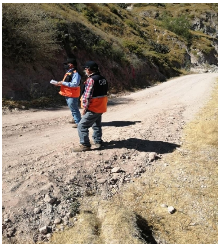
Figura 13: Personal de Defensa Civil de Municipalidad de Torata inspecciona zona de deslizamiento, se observa talud de pendiente moderada-alta y material altamente meteorizado en la ladera inestable (agosto 2020).
