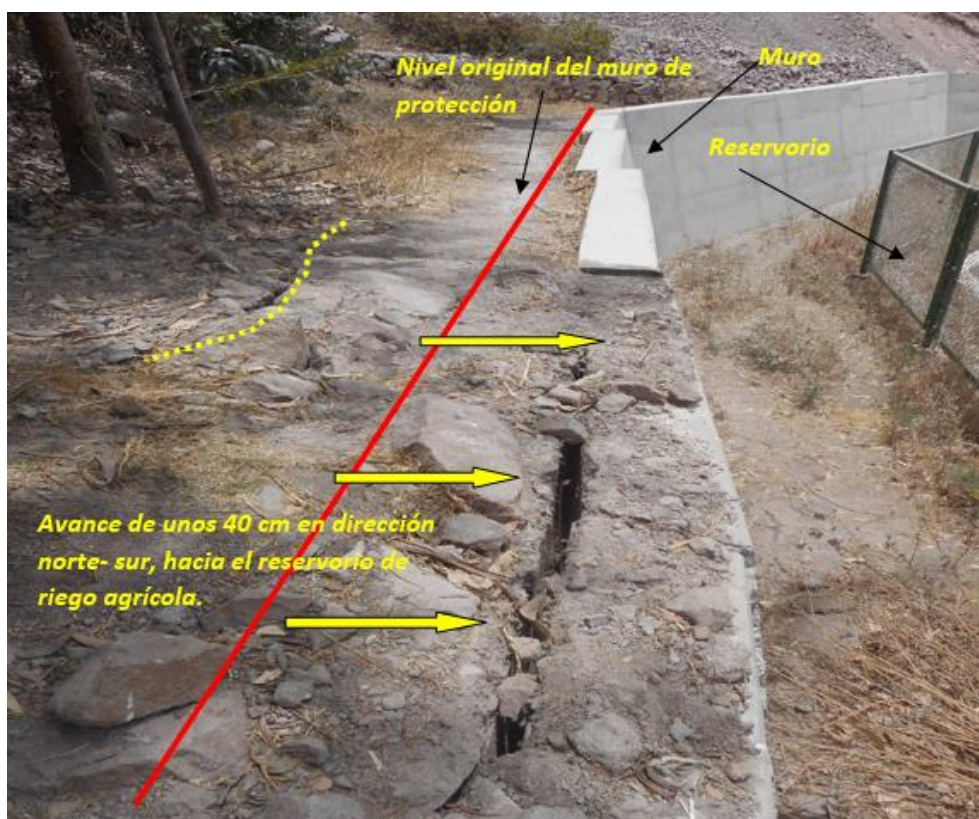
Figura 9: Agrietamiento del muro de protección del reservorio de agua a causa de la fuerza de empuje producto del deslizamiento de tierra.
