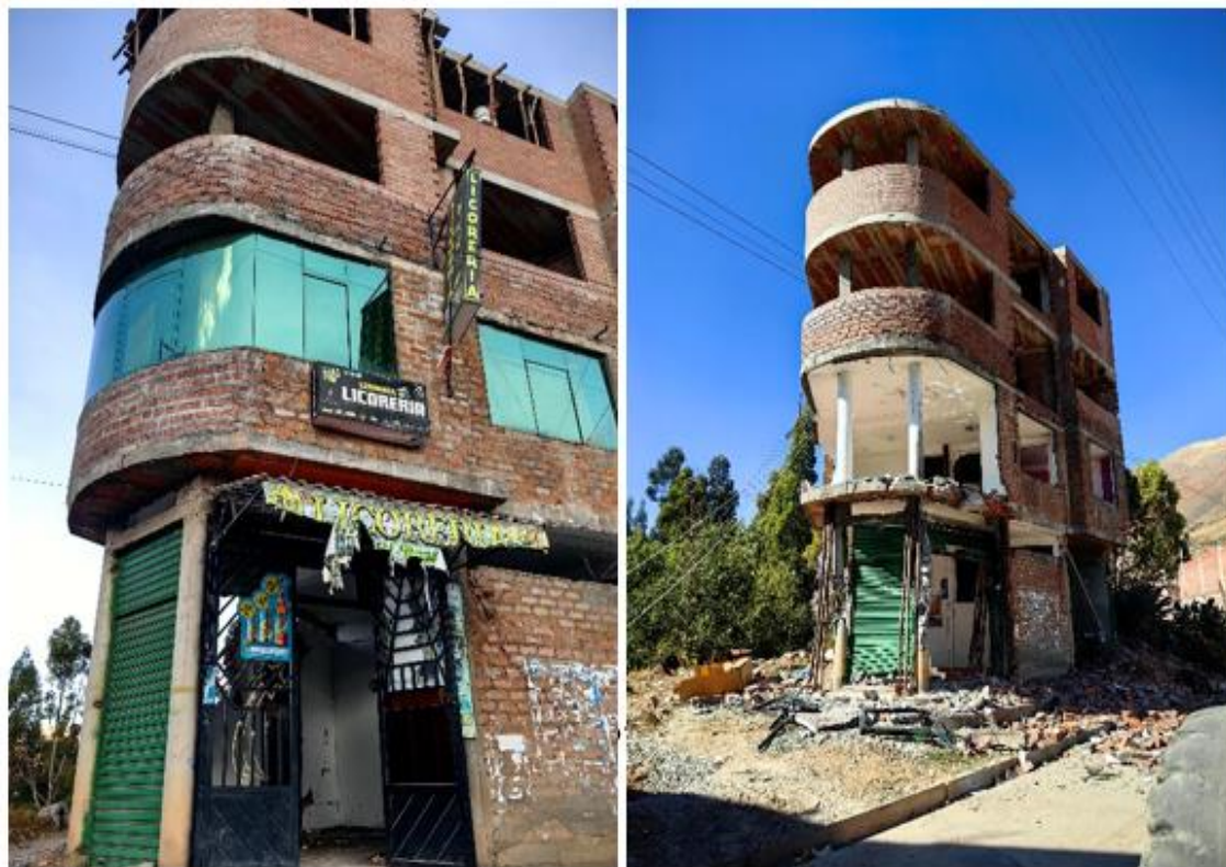
Figura 43.- Vivienda de 3 pisos dañado y demolido posteriormente
