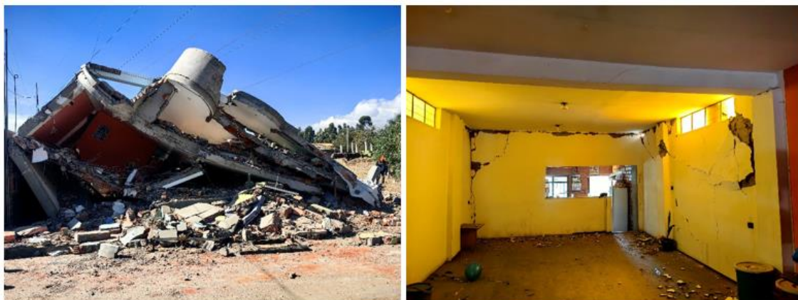
Figura 37.- Izquierda: Edificación de 4 niveles con daño severo recientemente demolido por la Municipalidad de Huancayo. Derecha: Vista interior de edificación de 3 niveles con daño severo en los muros portantes.
