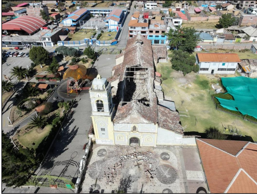
Figura 50.- Daños graves en la fachada y bóveda de la Iglesia Apóstol Santiago de Chongos Bajo
