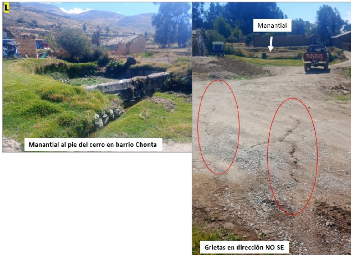
Figura 71.-. Identificación de grietas cercanos a la ubicación de manantes.
