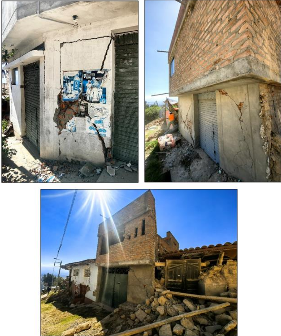
Figura 31.- Viviendas de albañilería con daños estructurales.
