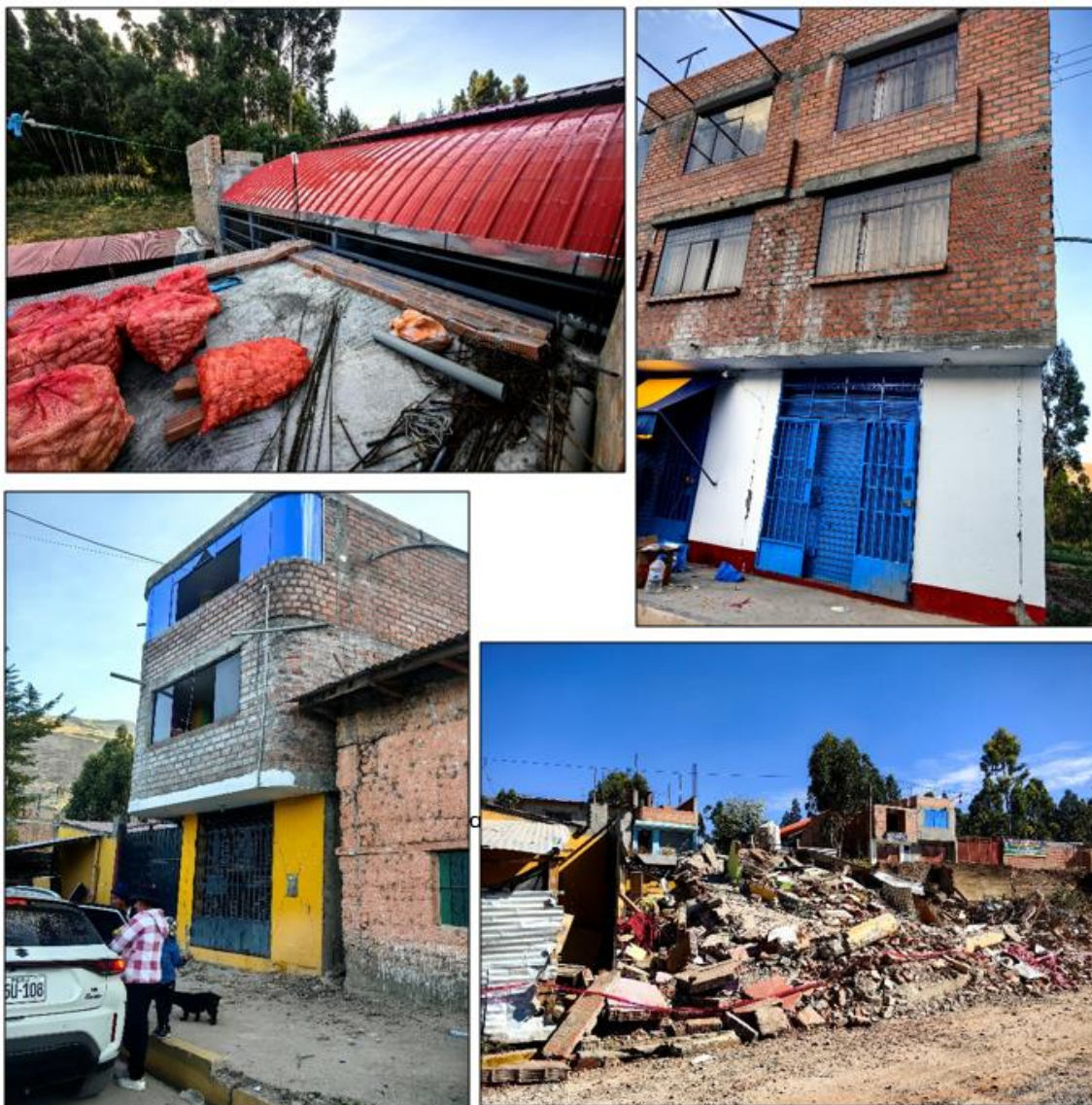
Figura 42.- Parapetos sin arriostre caídos, viviendas de 3 pisos dañados y demolidos posteriormente
