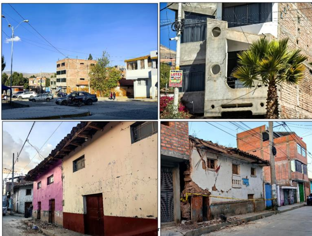
Figura 40.- Daños ligeros en viviendas en el entorno a la Plaza de Armas de Chupuro. La imagen derecha-abajo presenta daños graves
