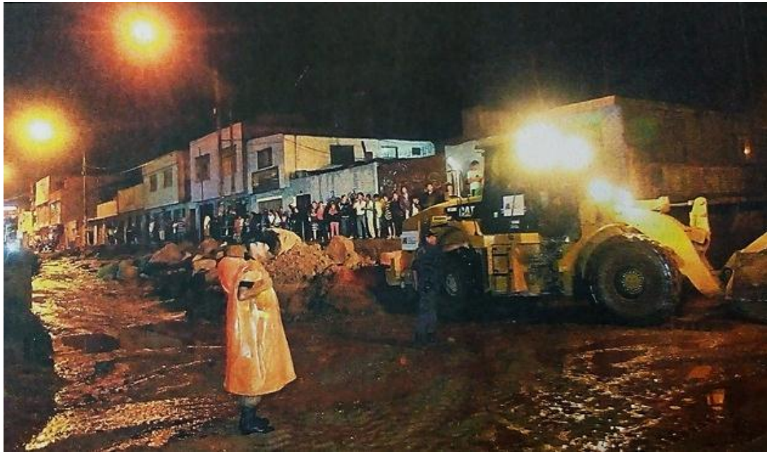
Chosica, 23/03/2015: 13 quebradas se activaron y la desolación se apoderó de la ciudad de Chosica. En la imagen se observa como maquinaria pesada intenta retirar rocas de las calles en la zona de Pedregal (Diario El Comercio)
