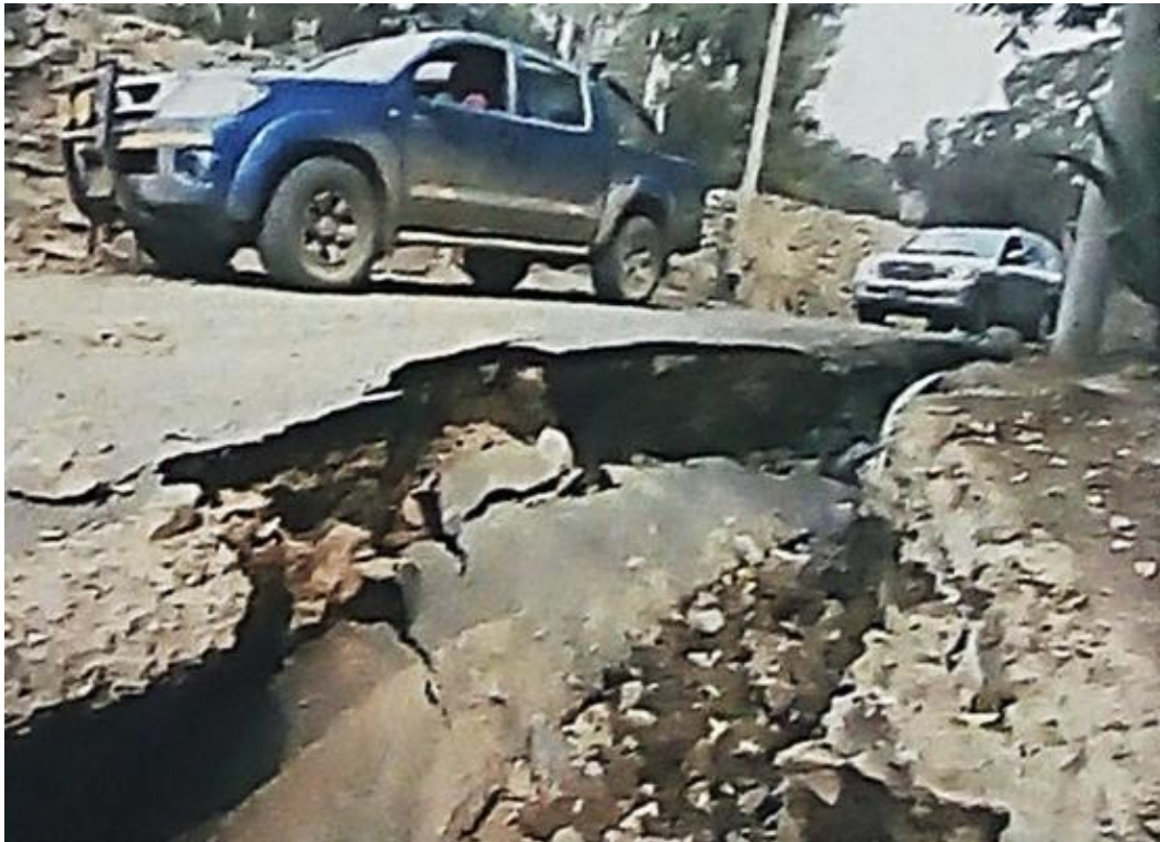
Chaclacayo, 07/04/2012: Pista en Los Cóndores sufrió agrietamiento (Diario El Comercio)
