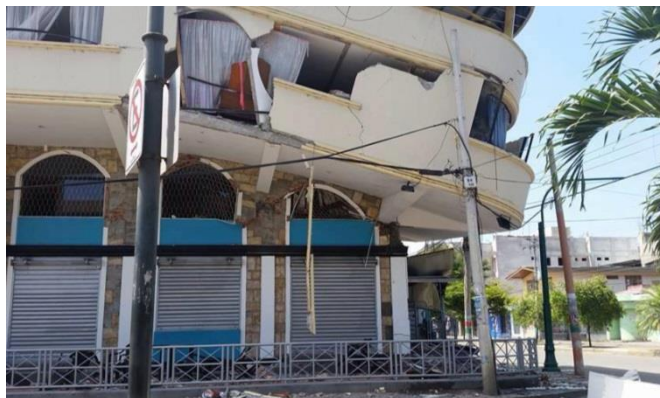
Fotografía N° 44. Inclinar por la presencia de volado después del sismo en Ecuador del 2016 (Vazcones, 2016)
