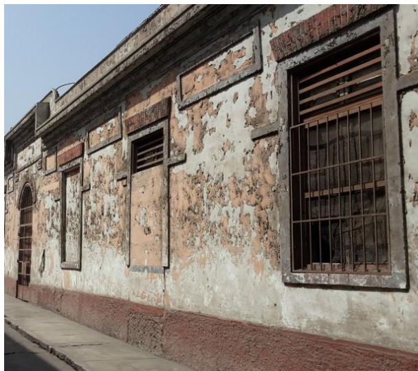
Fotografía N° 29: Vivienda de adobe en pésimo estado de conservación (Fuente: propia)
