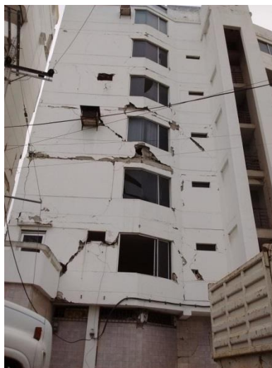
Fotografía N° 41. Vivienda de 8 pisos dañada por el sismo de Ecuador en el año 2016 (Vizconde, 2016)
