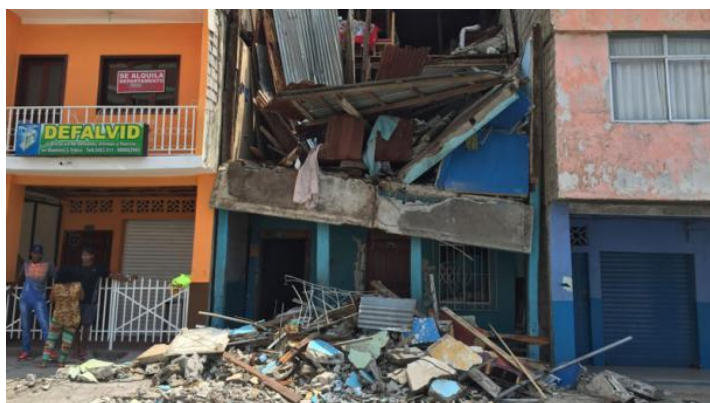
Fotografía N° 43. Techos de calamina colapsados después del sismo de Ecuador en el 2016 (El Comercio de Ecuador, 2016)
