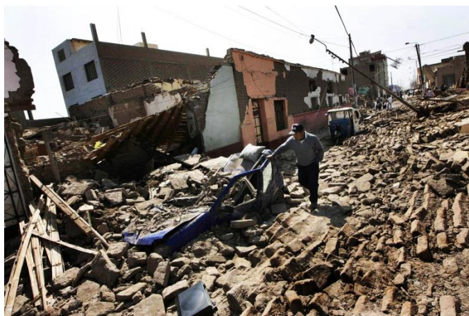
Fotografía N° 40. Viviendas de adobe desplomadas en el sismo de Pisco del 2007 (Peña, 2015)
