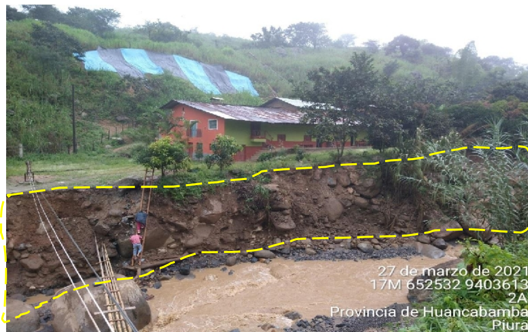
Figura 14: Erosión en el talud de ambas márgenes de la quebrada Pusmalca. Las viviendas asentadas en la margen derecha de la quebrada se encuentran en riesgo
