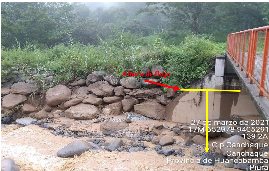
Figura 12: En el puente que comunica Canchaque con el sector Agua Azul, el flujo alcanzó alturas de 2.20 m
