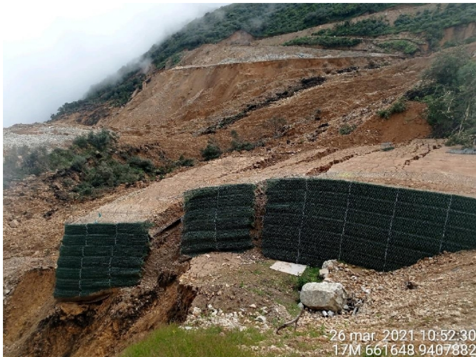
Figura 9: Las estructuras del DME 111 con presencia de grietas y remoción de sus componentes por efectos de la gravedad. Asimismo, se observa el desplazamiento de materiales pendiente abajo
