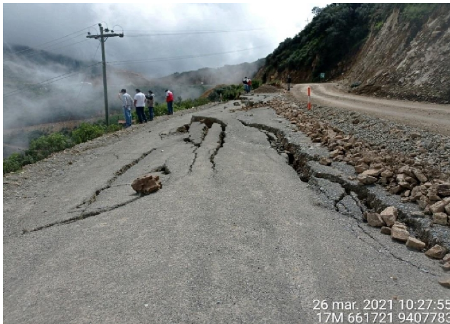
Figura 7: Grietas de 0.20 m de ancho y profundidades de 1.20 m, así como asentamientos diferenciales en la vía Canchaque – Huancabamba
