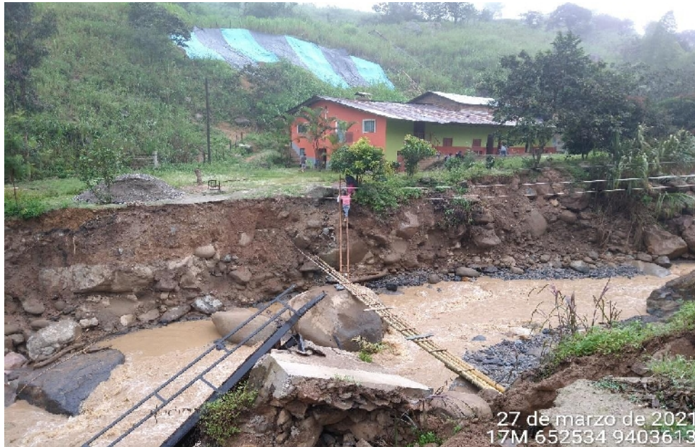
Figura 13: El puente que une Canchaque con el Sector Chirigua fue afectado por la presencia de grandes bloques de roca dejando incomunicado a dicho sector
