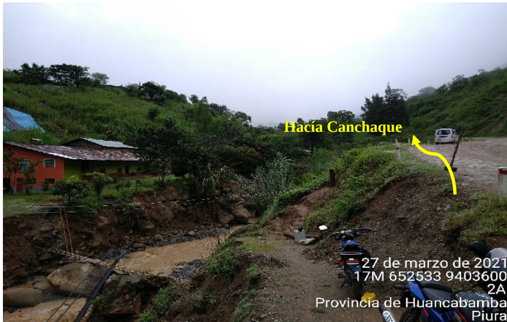
Figura 15: En la margen izquierda de la quebrada Pusmalca, la erosión generada por el flujo podría afectar la vía principal hacia Canchaque – Huancabamba
