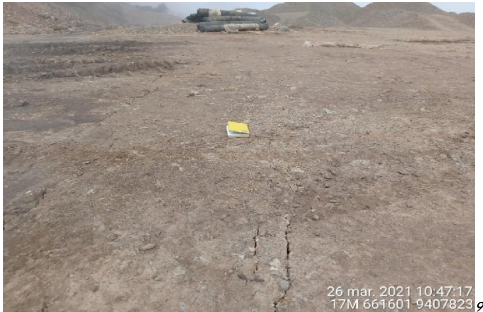
Figura 22: Grietas sobre terraplén conexo al DME-111
