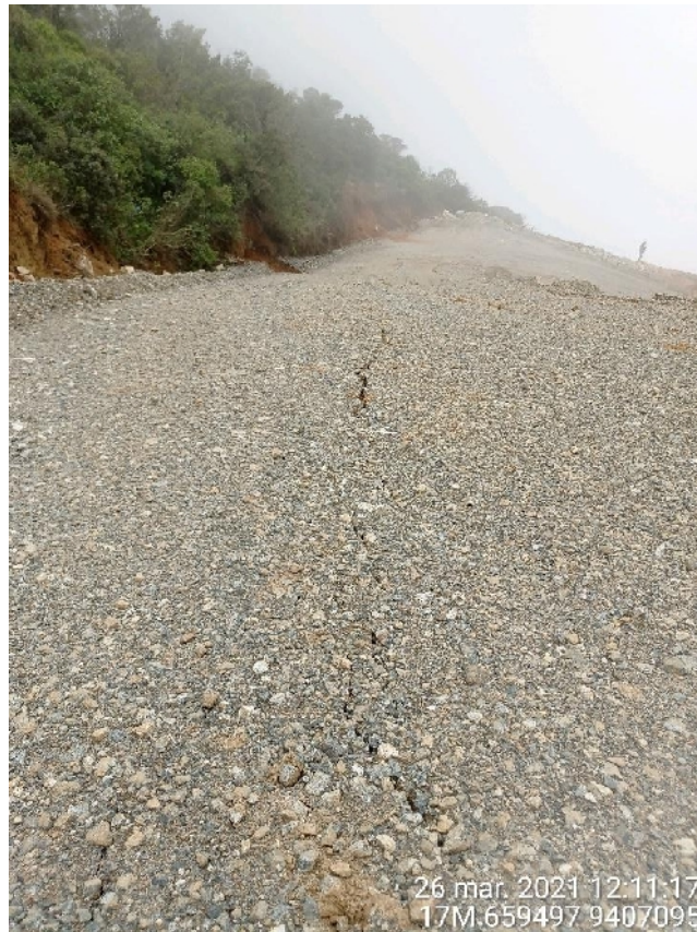
Figura 24: Grietas en terraplén del DME-105
