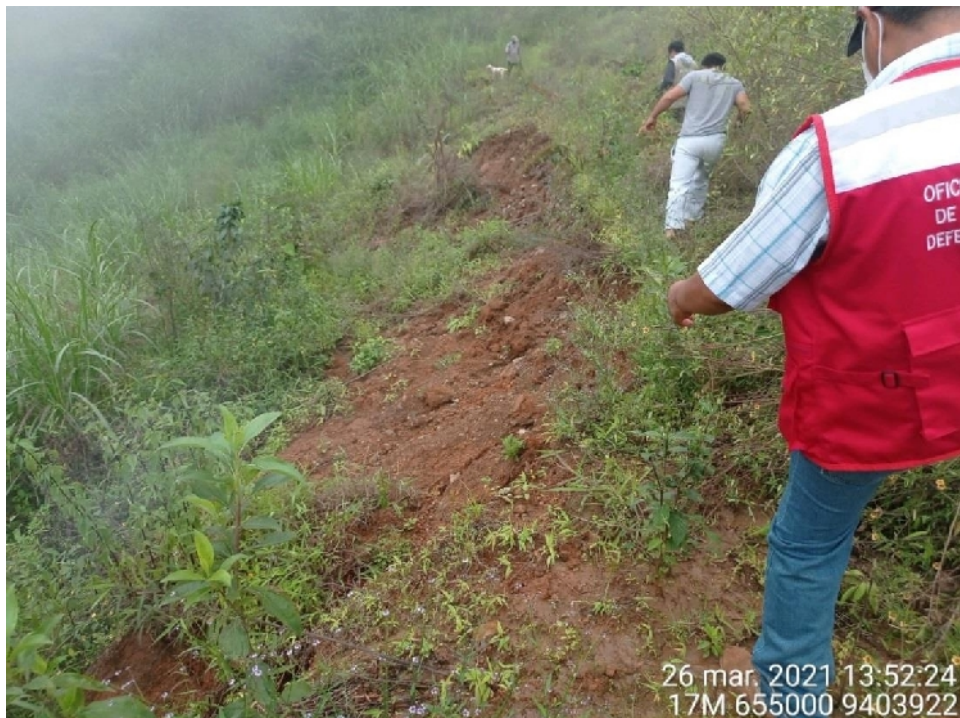
Figura 28: Derrumbes en taludes próximos al DME-04, a consecuencia de la saturación de agua en los materiales que conforman el talud.
