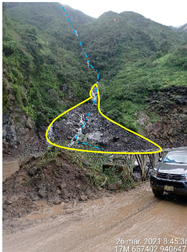
Figura 19: Materiales inestables ubicados en la parte alta del puente Fierro
