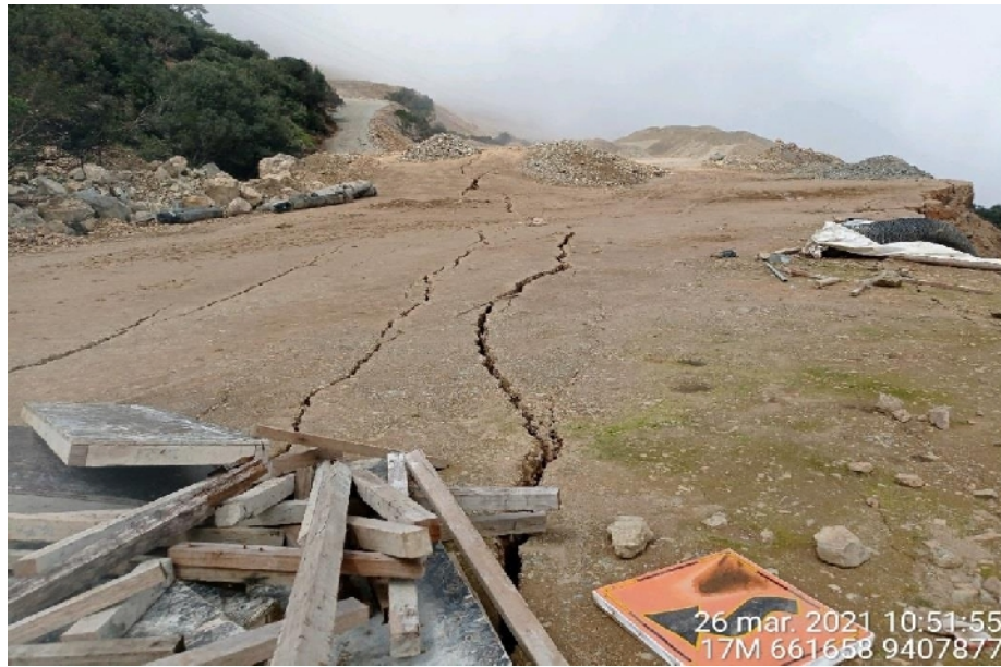
Figura 8: Grietas en los suelos que conforman parte del botadero (DME111) y que indican el posible desarrollo de un nuevo deslizamiento
