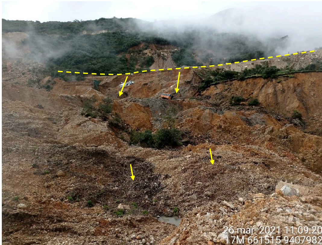
Figura 5: Materiales deslizados pendiente abajo desde zona de arranque. Los materiales están inconsolidados y con presencia de agua
