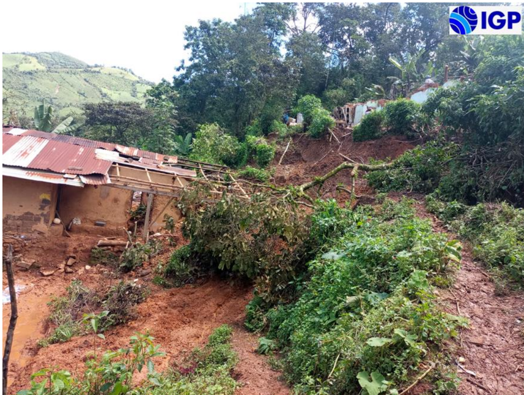
Figura 37.- Derrumbe ocurrido en el sector Anexo San José de Pite que afectó viviendas.
