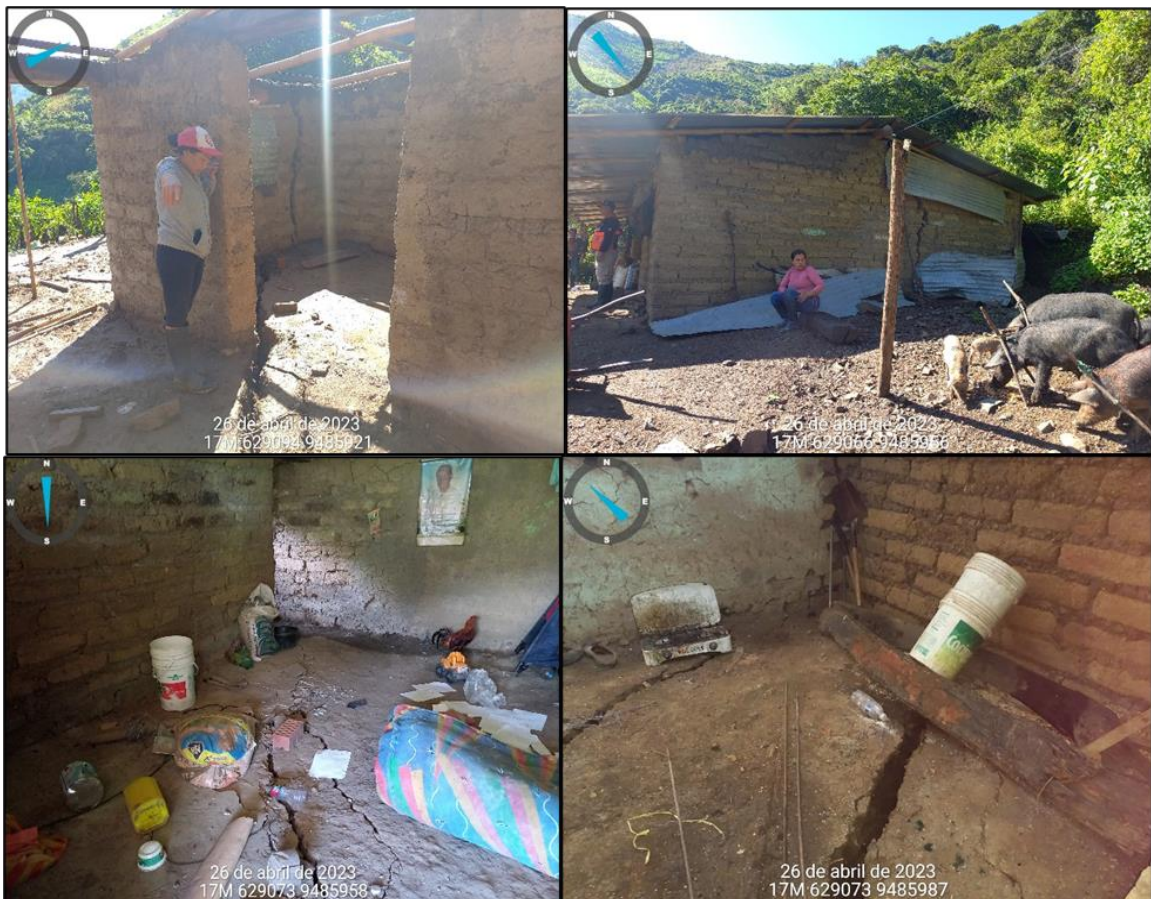
Figura 39.- Evidencias del deslizamiento son las grietas identificadas en las viviendas (imágenes superiores) y suelo (imágenes inferiores) en algunos casos se ha generado el colapso de las paredes
