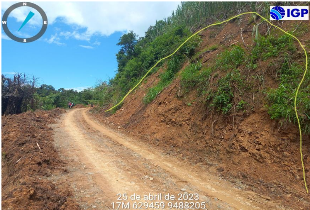
Figura 31.- Deslizamiento (debajo de línea amarilla) ocurrido el presente año, posterior a las lluvias intensas ocurridas el presente año, afectó parte de la vía Montero – Santa Cruz.
