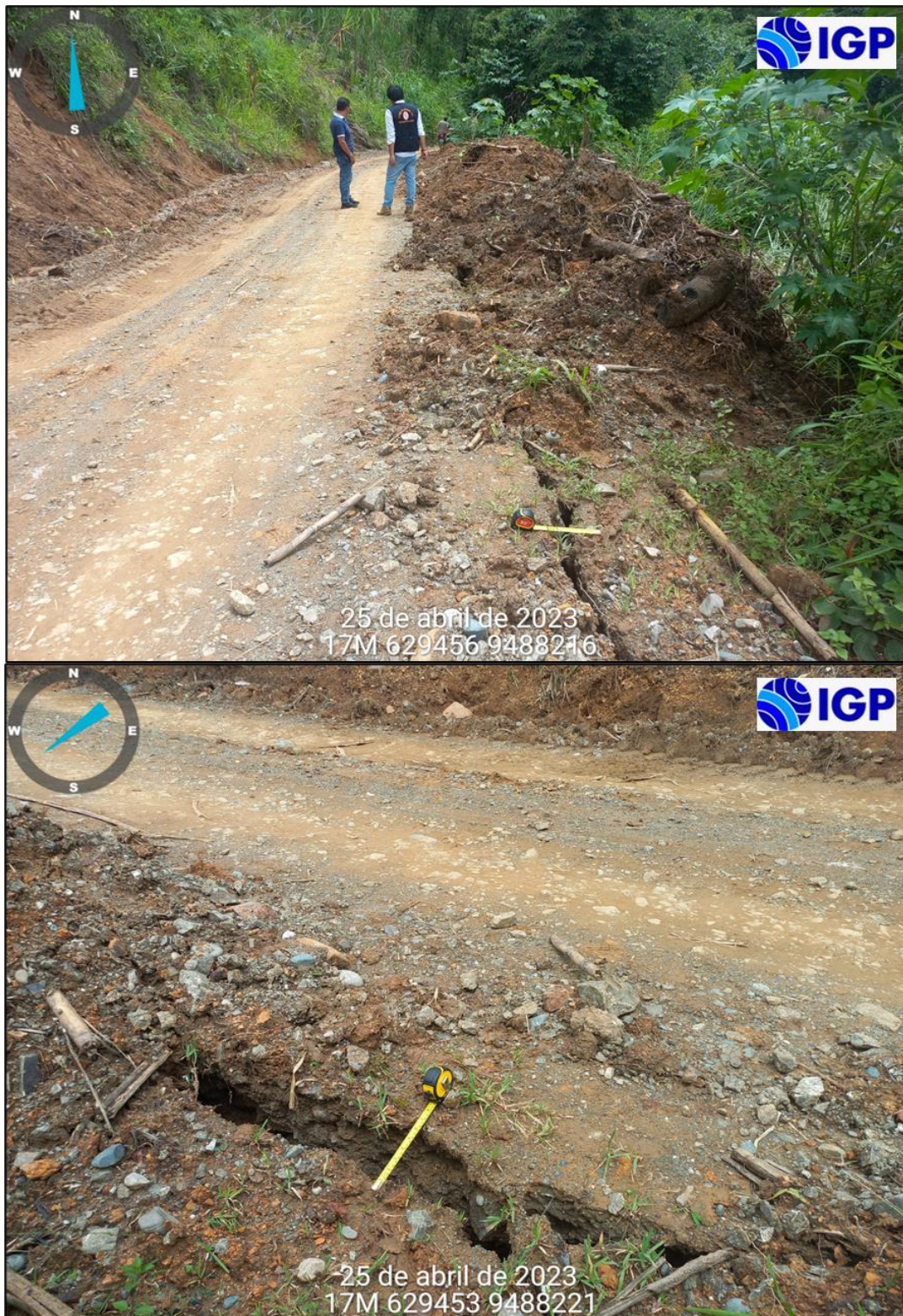
Figura 32.- Grietas en las inmediaciones de la vía Montero – Santa Cruz.
