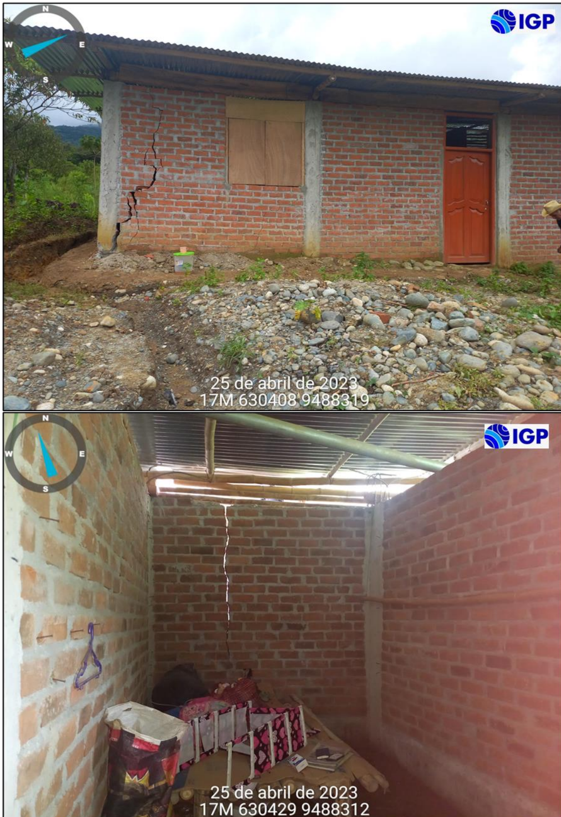
Figura 35.- Grietas en viviendas situadas sobre arcillas saturadas que vienen siendo afectadas por el fenómeno reptación de suelos
