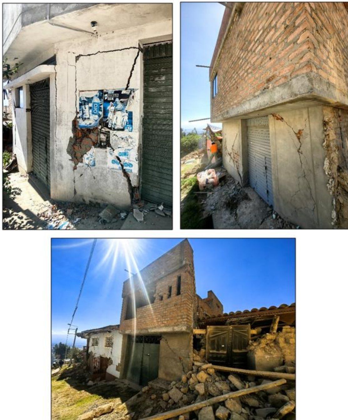
Figura 31.- Viviendas de albañilería con daños estructurales.
