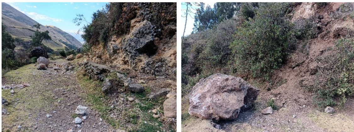
Figura 22- Caída de rocas en vía no pavimentada, sector Pumpunya.
