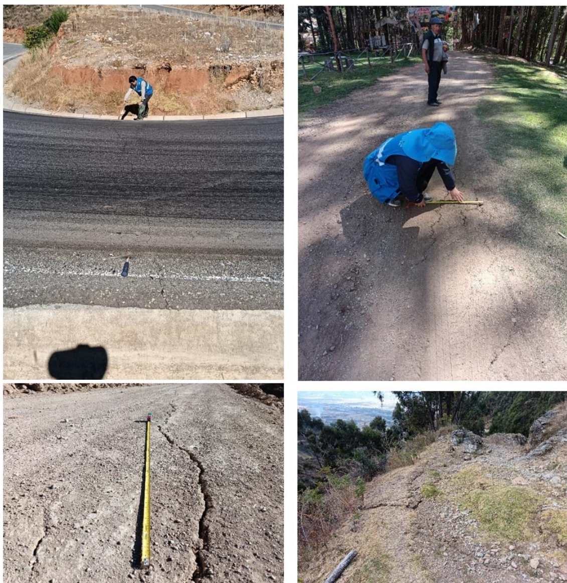
Figura 18.- Agrietamientos superficiales con orientación predominante NW-SE entre los sectores Tinyari Chico, Pumpunya y Chonta
