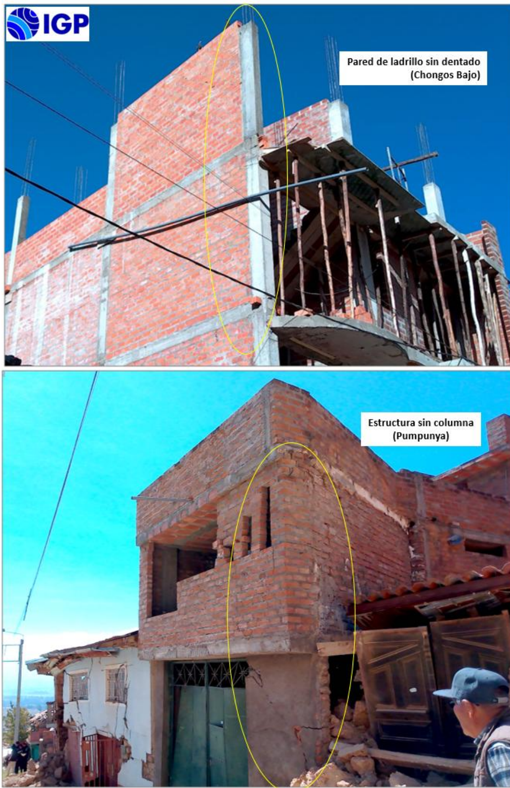
Figura 74.-. Edificaciones con deficiencias constructivas en los distritos de Chongos Bajo y Pumpunya.
