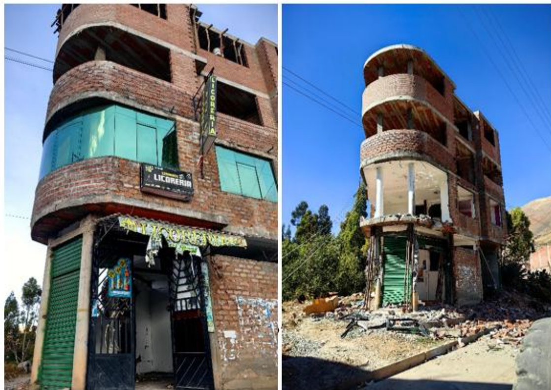
Figura 43.- Vivienda de 3 pisos dañado y demolido posteriormente
