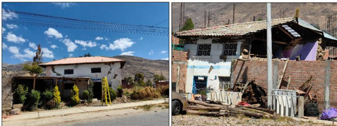
Figura 45.- Viviendas de adobe con daños moderados y graves en el sector Barrio Saños
