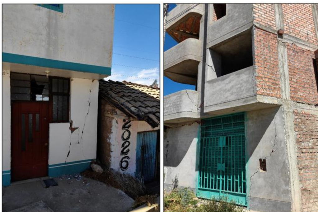
Figura 46.- Izquierda: vivienda de albañilería de 2 pisos con daño moderado. Derecha: vivienda de 4 pisos con daños muy graves y con ligera inclinación sobre el terreno
