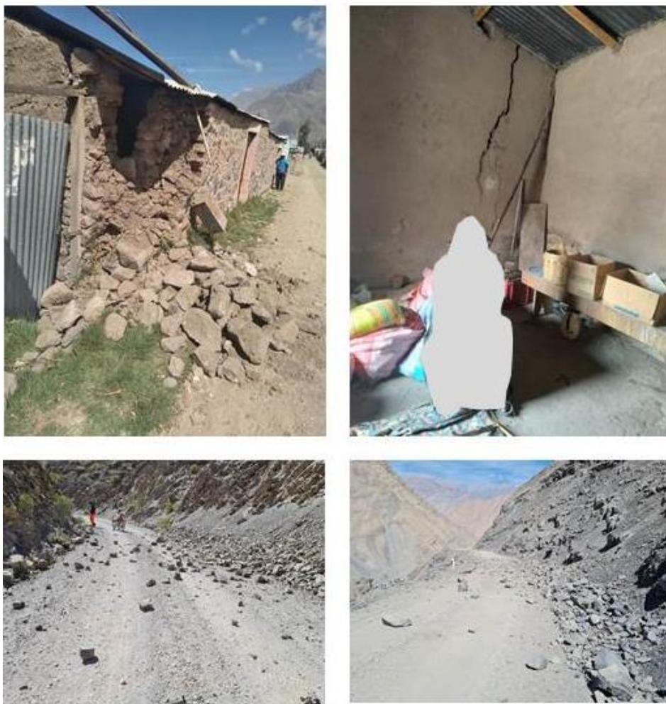
Figura 5: Daños en viviendas de adobe en las localidades de Cabanaconde y Pinchollo, así como escenarios donde se han producido la caída de piedras y tierra afectando a las carreteras.
