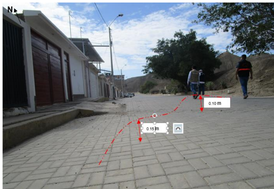
Figura 46: El adoquín de la calzada presenta ondulamientos con desniveles entre 0.10 y 0.15 m.
