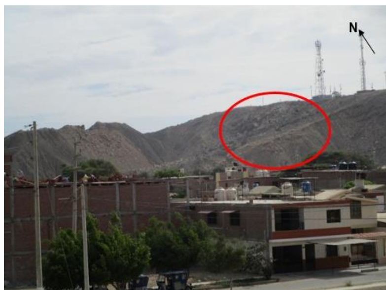
Figura 33: Caída de rocas en el sector urbano oeste.
