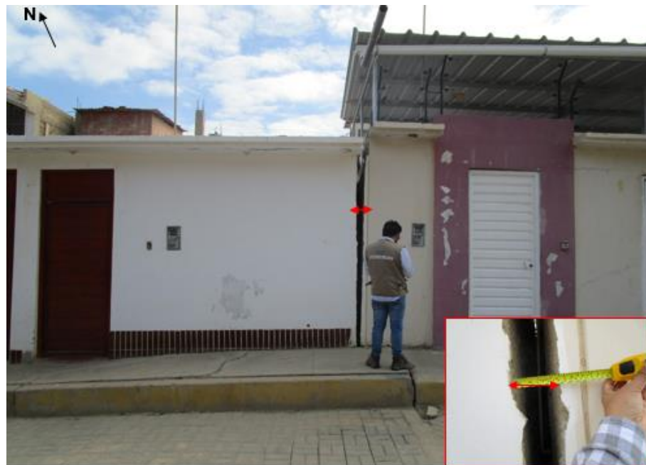
Figura 45: Asentamiento de las estructuras, separación mayor a 5 cm, entre las edificaciones colindantes.
