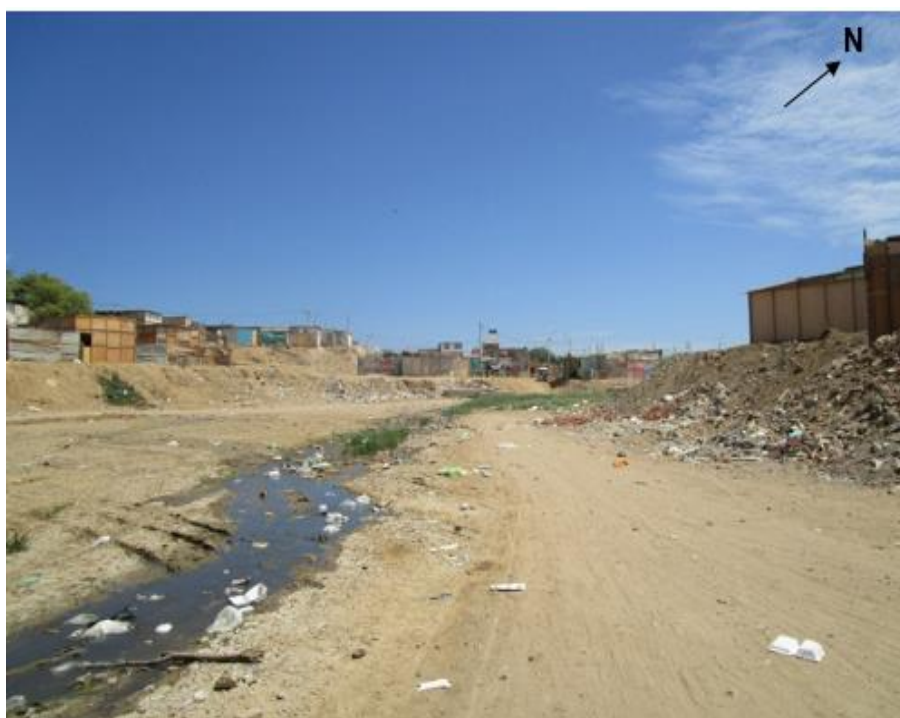
Figura 40: Colapso de red de desagüe en el AA.HH. Ampliación San Sebastián.
