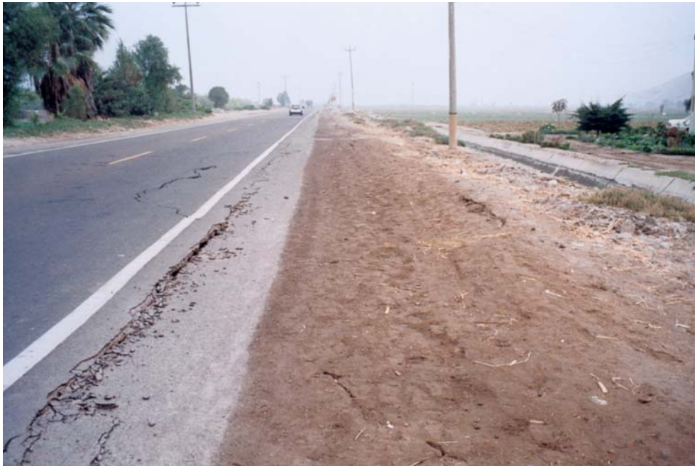
Foto 3.- Agrietamiento de la calzada por colapso del terraplén de la carretera por lateral spread, inducido por la presencia de un canal de riego en tierra ubicado a la izquierda de la foto (al oeste; al pie de la arboleda). El colapso ocurre bajo la forma de “micro-grabenés” subparalelos al eje vial.
