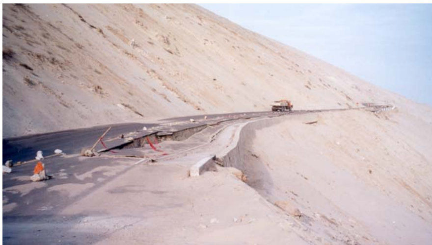
Foto 2.- Colapso de la calzada por falla del terraplén de relleno de la carretera Panamericana sur, afectando muros de contención, en sectores de arenas eólicas no consolidadas.
