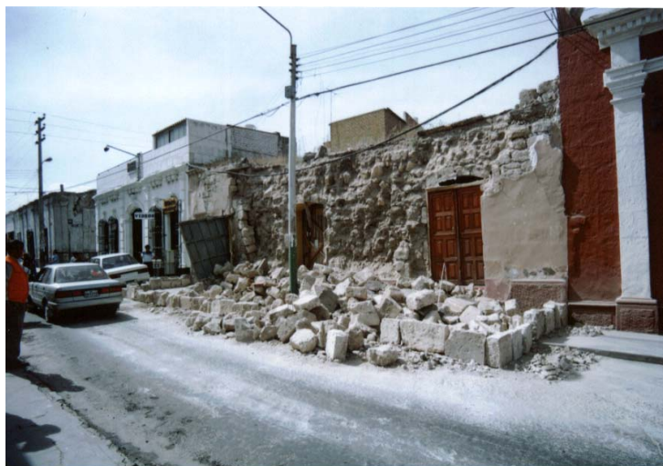
Foto 2.- Calle Rivero, desplome de una pared de sillar.
