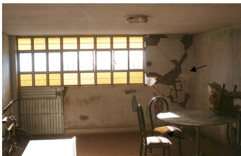
Foto 20.-Vivienda ubicada en Tingo Grande, distrito de Hunter. Rajaduras en una de sus paredes.
