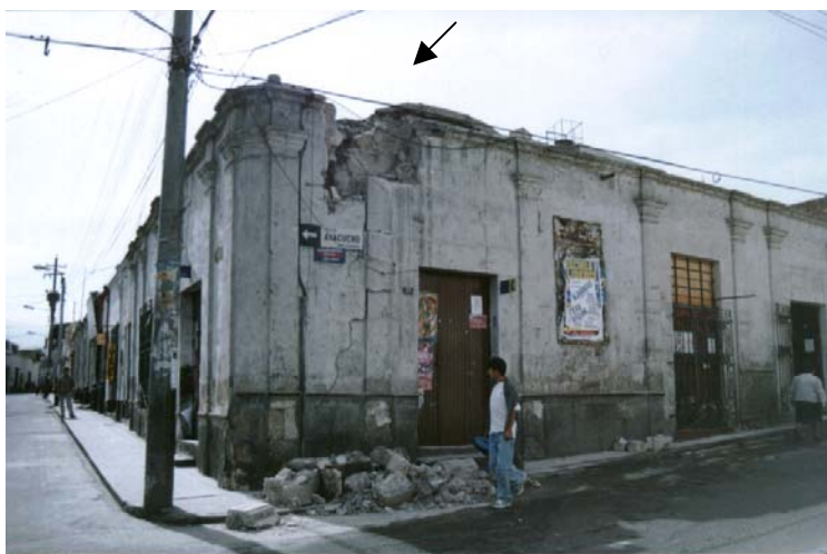
Foto 3.- Esquina entre las calles Ayacucho y Rivero. Colapsó parte de una vivienda de sillar.
