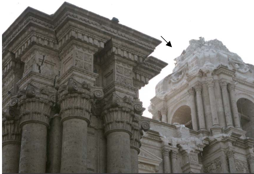
Foto 9.- Catedral de Arequipa. Vista de la torre del extremo izquierdo y portales seriamente agrietados.
