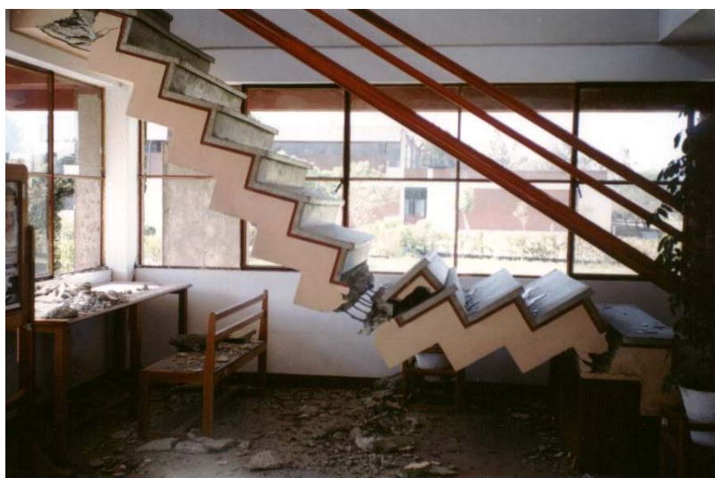
Foto 4.- Biblioteca de Ingenierías de la UNSA. Imagen que muestra los daños sufridos en las gradas de esta estructura.
