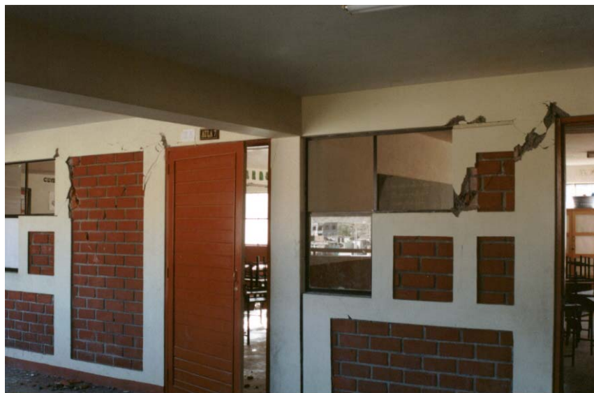
Foto 21.-Colegio San Agustín de Hipona 40033, distrito de Hunter. Presenta profundas fisuras.
