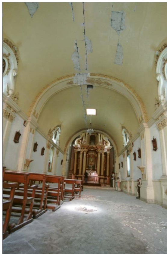
Foto 11.- Iglesia San Lázaro, presenta grietas profundas en su techo.
