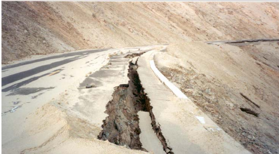
Figura 8. Tramo Atico-Pescadores, Panamericana Sur – Sector Cerro de Arena . Agrietamientos en la carpeta asfáltica por falla del borde lateral en zonas de aspersiones eólicas.
