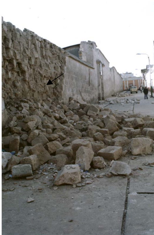
Foto 12.-Calle Ugarte. pared posterior del monasterio de Santa Catalina colapso parcialmente.
