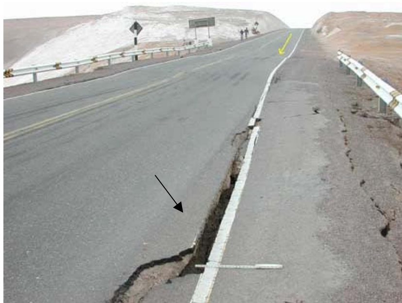
Foto 27.-Carretera que une Mollendo y el Valle de Tambo. Observese el nivel de hundimiento de la carretera
