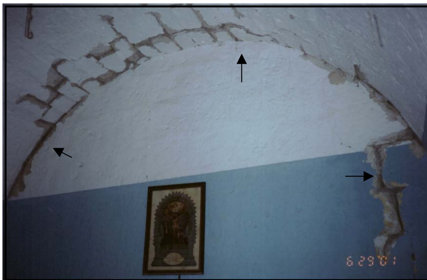
Foto 22.-Iglesia San Fernando, distrito de Socabaya. Infraestructura muy deteriorada.
