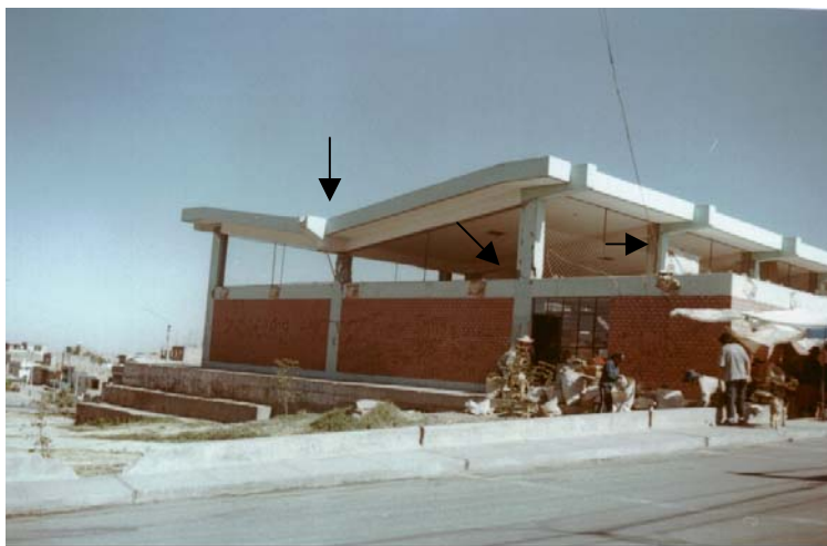
Foto 15.- Mercado Villa Hermosa, distrito Selva Alegre. daños en su estructura y sus columnas están a punto de caer.
