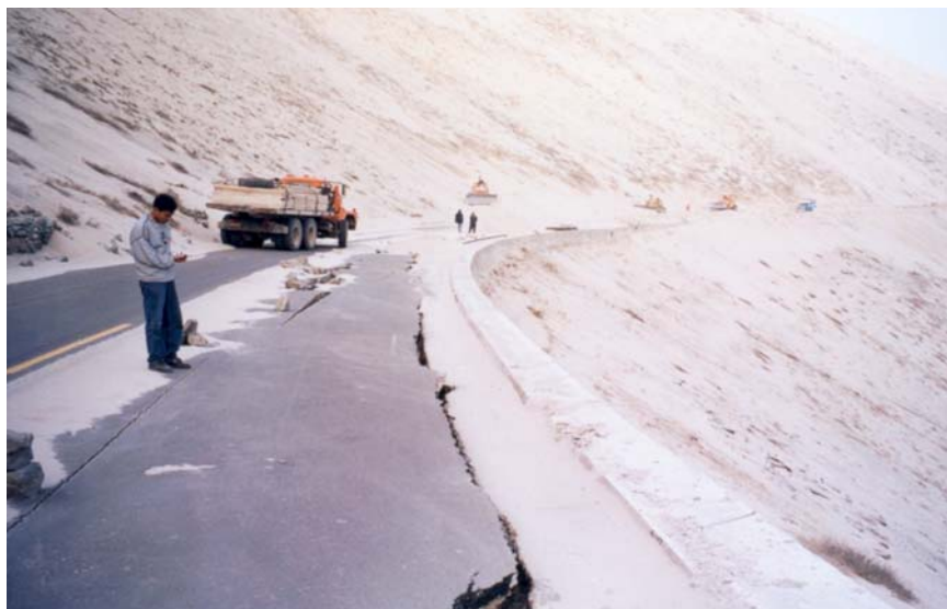
Foto 1.- Caída de depósitos eólicos en cortes de la carretera Panamericana sur, entre Atico y Ocoña, en fase de remoción después de sismo secundario (05/07/2001). Obsérvese también falla del muro de contención.
