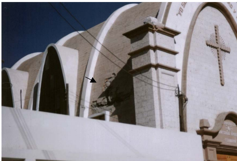
Foto 18.-Iglesia Tunales, distrito de Tiabaya. Fisuras en la bóveda y paredes.
