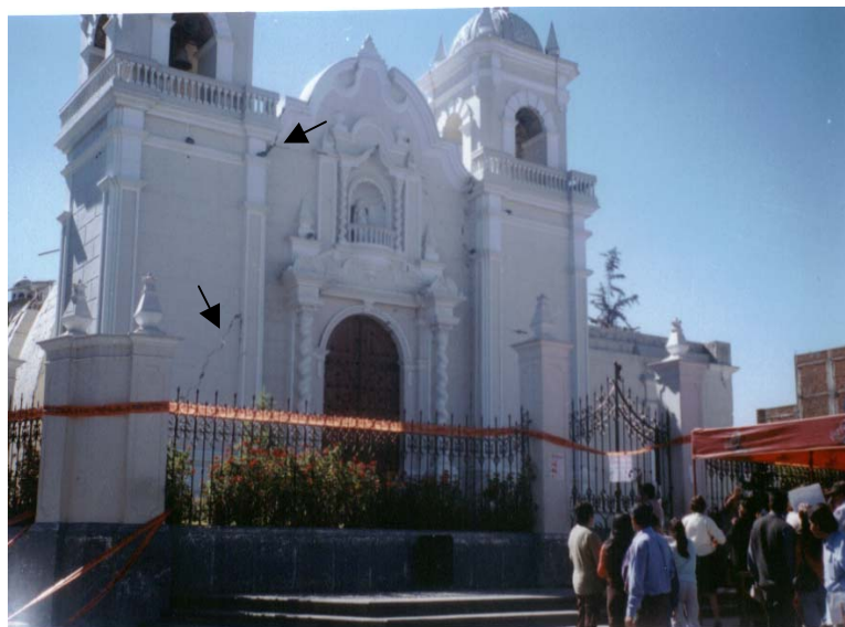
Foto 10.- Iglesia de Santa Martha. Sus estructuras presentan fisuras profundas.
