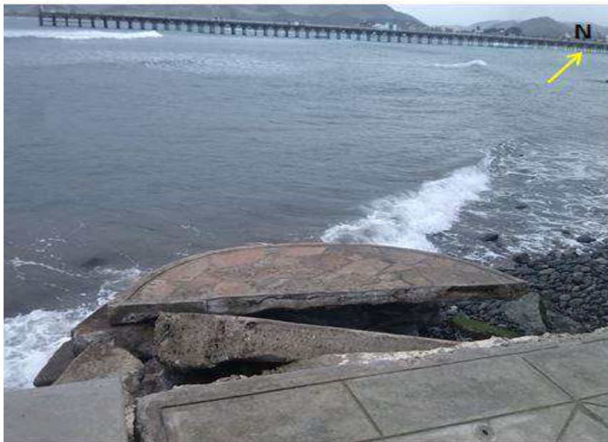
Figura 29: Balneario Cerro Azul, obsérvese los escalones dañados por el oleaje..
