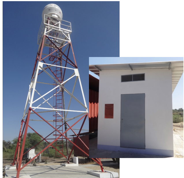
Figura 2. A la izquierda se muestra la torre metálica de 10 metros de altura, con la antena parabólica en su parte superior, y a la derecha la cabina de seguimiento con los equipos electrónicos del radar de lluvias.
