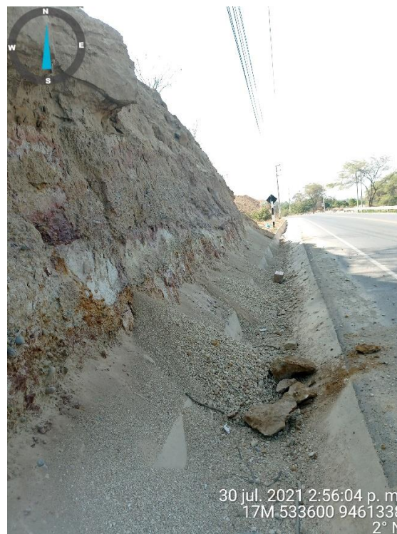
Figura 2.- Derrumbes en la vía Marcavelica – Querecotillo que colmataron la cuneta de drenaje
