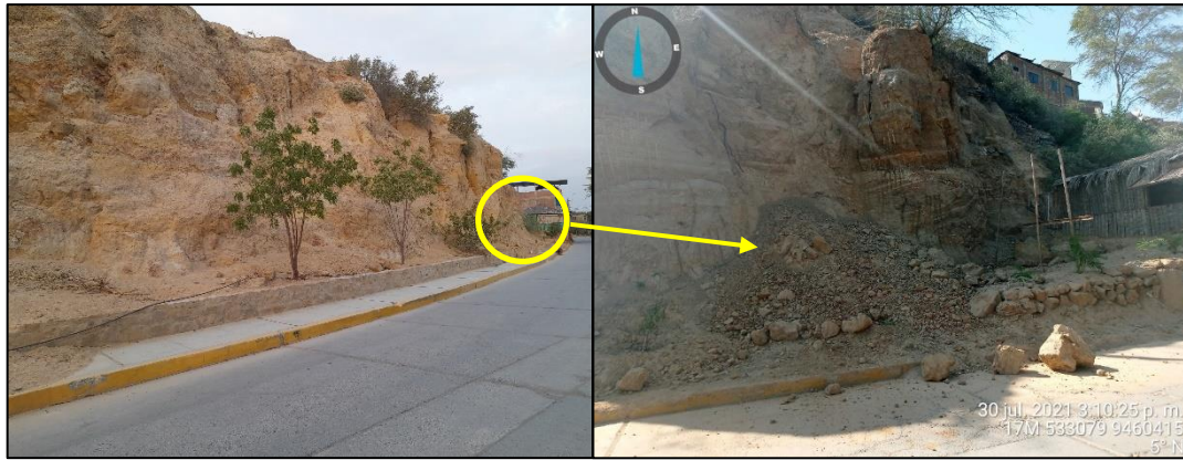
Figura 1.- Ladera de pendiente subvertical ubicada en la Av. Sullana donde se presentaron derrumbes de materiales durante el sismo del 30 de julio de julio
