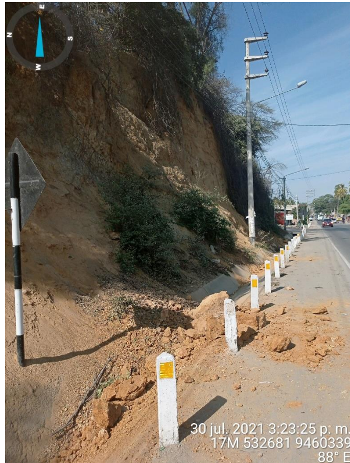
Figura 3.- Derrumbes en la ladera ubicada en la vía Marcavelica - Mallaritos
