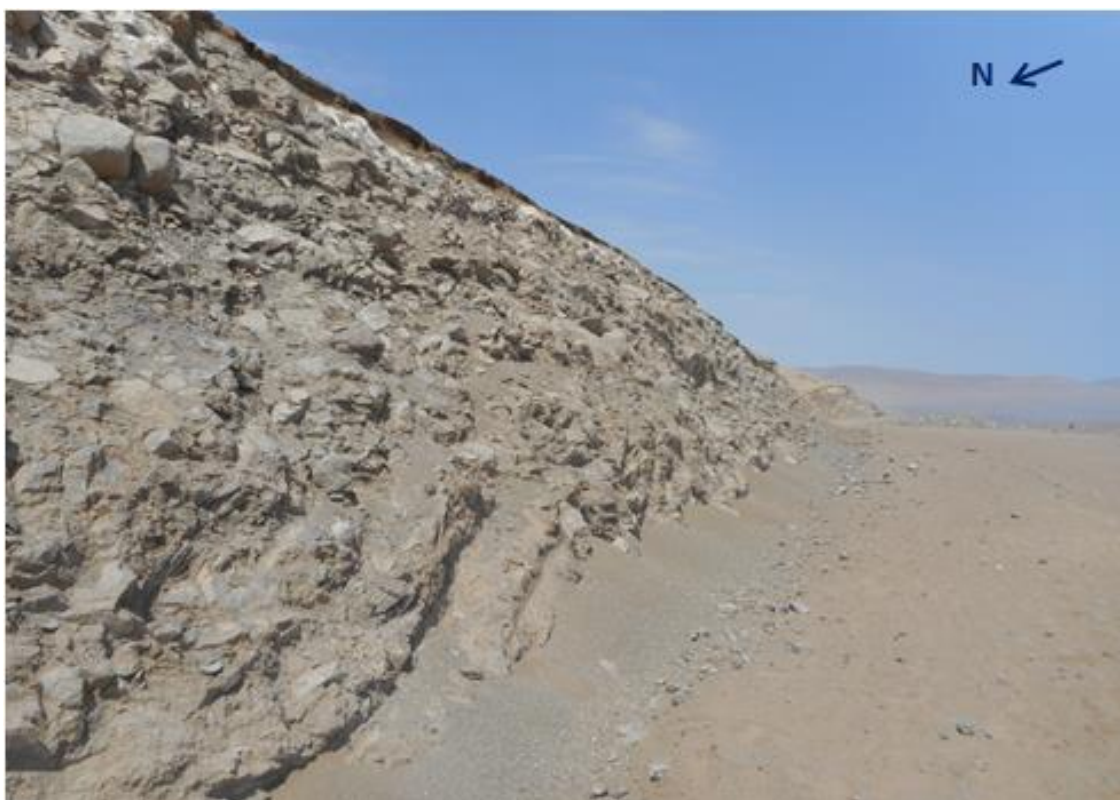
Figura 29: Zona susceptible a caída de rocas debido a la meteorización del afloramiento.
