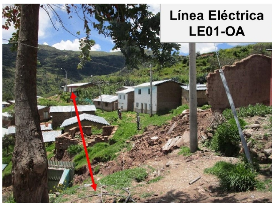
Figura 79. Vista de la línea eléctrica de Ocho de Agosto (LE01-OA).
