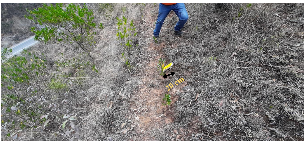
Figura 8.- Escarpas con desplazamiento de material (arcilloso y gravas) de aproximadamente 20 cm, se han identificado en la cima de la zona de arranque del derrumbe, por lo que el evento sigue activo.
