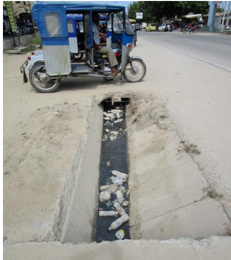
Figura 25: Inundaciones pluviales generadas por la falta de mantenimiento de cunetas.
