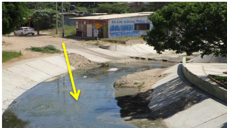
Figura 24: Sedimentación en el Canal Vía, esto impide el fácil flujo de las aguas hasta su desembocadura (río Chipillico). La flecha amarilla indica la dirección del flujo.
