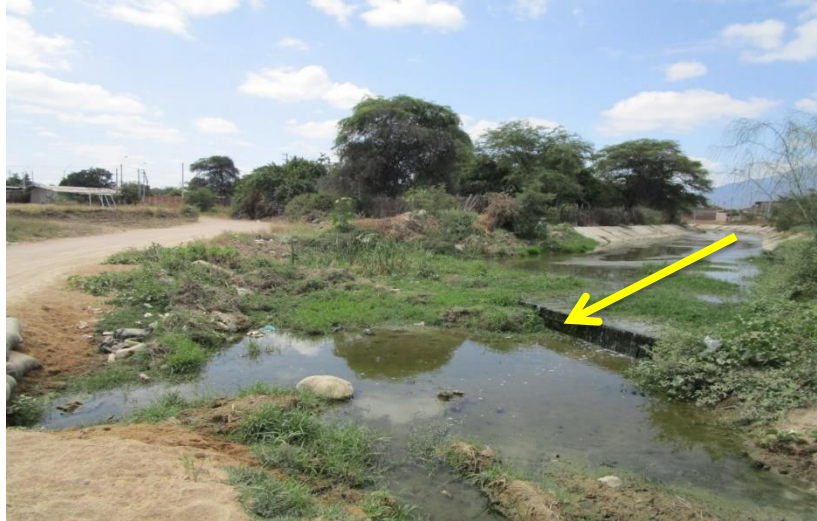
Figura 22: Hasta el límite del AA.HH. Bellavista con Juan Velazco esta canalizada la quebrada, posterior a este límite encuentra obstruida y angosta que y en épocas de lluvia se desborda e impide el paso de vehículos a otros anexos. La flecha amarilla indica la dirección del flujo.
