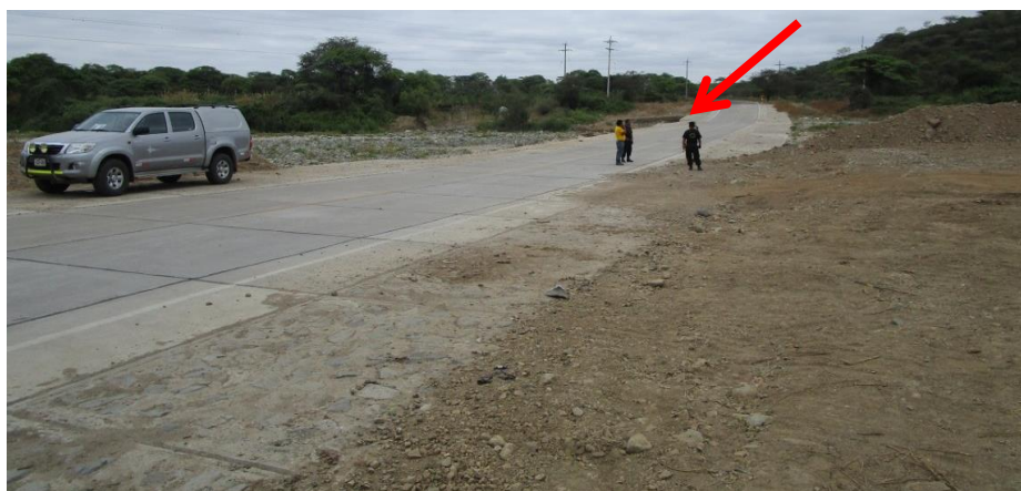
Figura 18: Al activarse la quebrada Hawái de Pava, interrumpe el paso dejando incomunicada a Pampa Elera Alta y Potrerillo.
