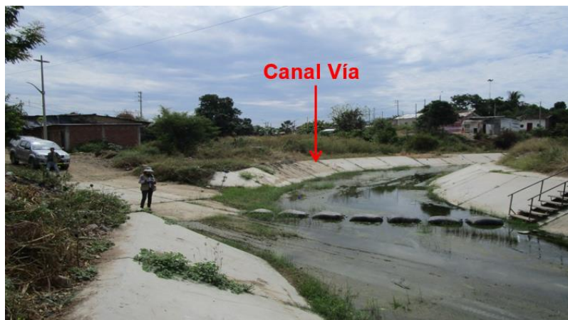
Figura 21: Canal Vía, en épocas de precipitaciones se desborda afectando a los AA.HH. de Buenos Aires, Miraflores, Santa Rosa, Juan Velazco y casco urbano de la ciudad de Las Lomas.
