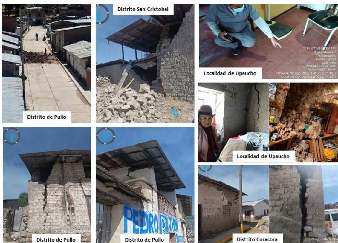
Figura 6.- Daños en viviendas de adobe debido al sismo de Ayacucho del 20 de agosto 2026 (Fuente: redes sociales).
