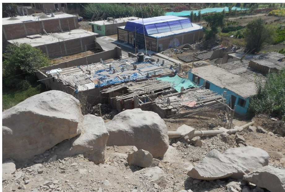
Figura 19: Caída de rocas localizada al noreste de la zona urbana del distrito de San Luis y que podrían afectar la seguridad física de la población del A.H. Los Ángeles
