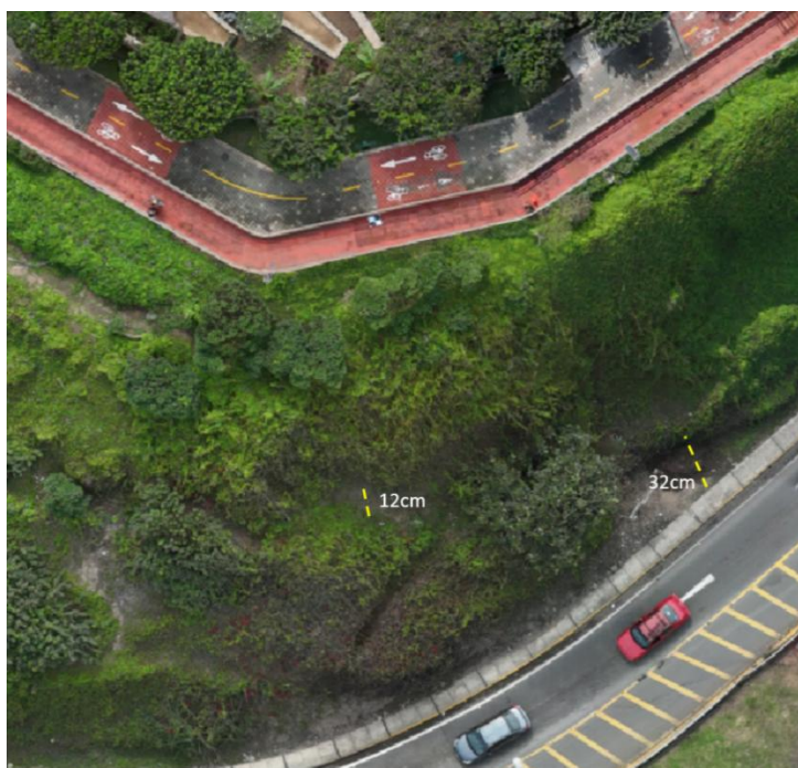
Figura 14. Desprendimientos localizados de hasta 32cm en el talud frente al Parque Bicentenario, (punto 6 en Figura 8).
