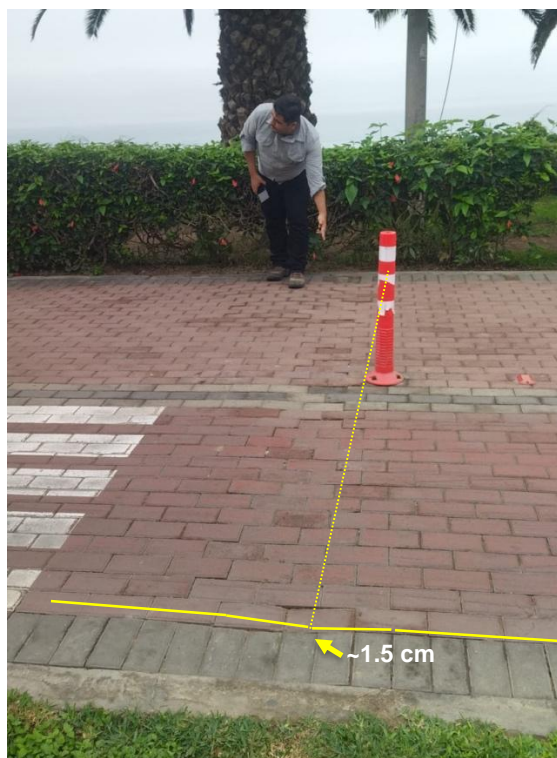
Figura 11. Evidencia de ligero hundimiento en el Malecón Godofredo García, al sur del Parque Bernales.
